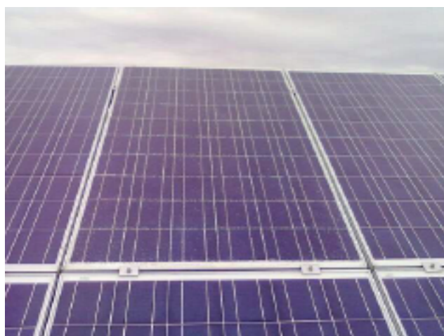
Tavola n. 21: Modulo con superficie compromessa
