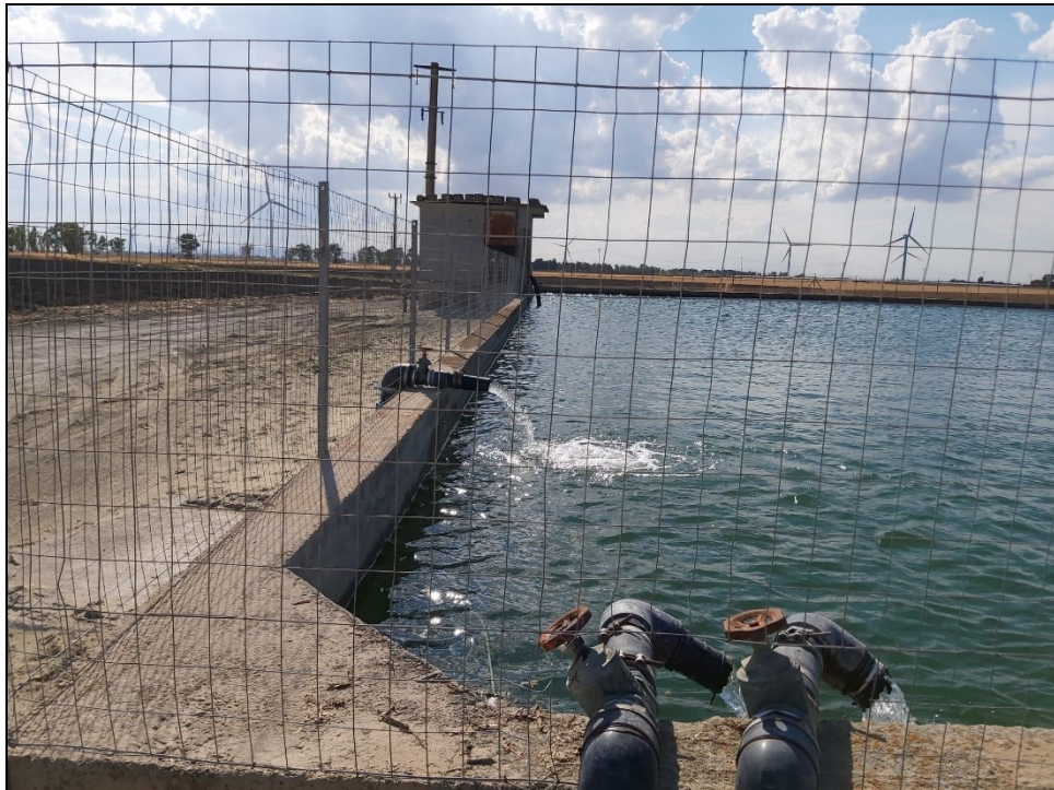
Impianto irriguo: vascone raccolta acque di irrigazione
