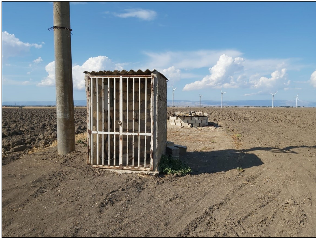
Impianto irriguo: gruppo elettropompa filtro
