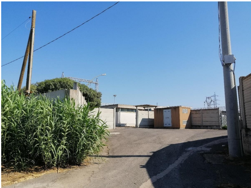
Oristano, centrale elettrica di trasformazione a ridosso della località di Perda Longa.
