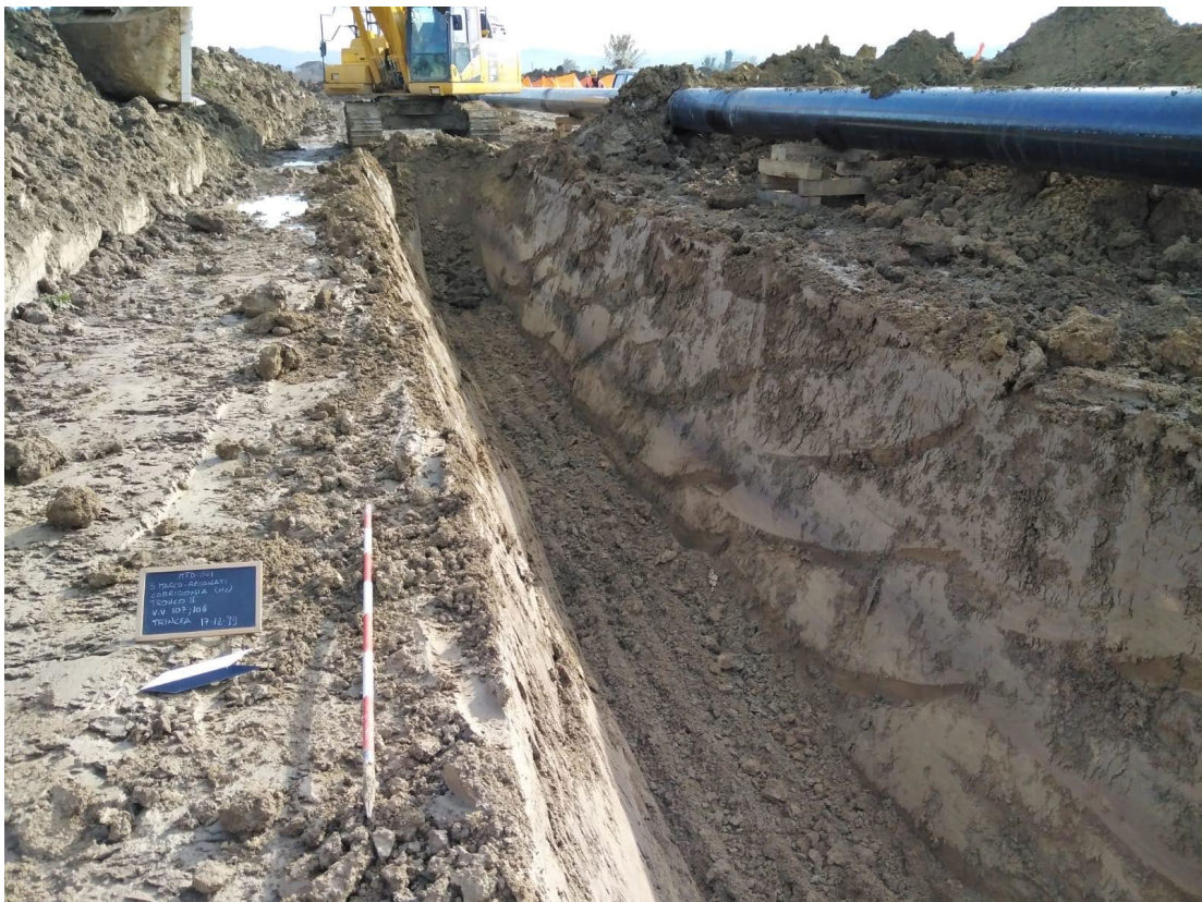
4.15 –Asse scavo, foto d’insieme - vista NW in direzione SS77 del vertice di cantiere 107 – 106 / tronco II.
