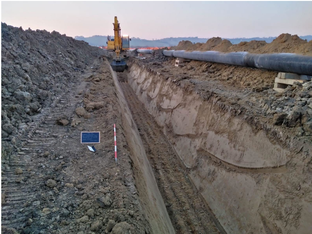
Fig. 4.4 – Asse scavo, foto d’insieme - vista NS in direzione Fiume Chienti del vertice di cantiere 104 – 103 / tronco II.
