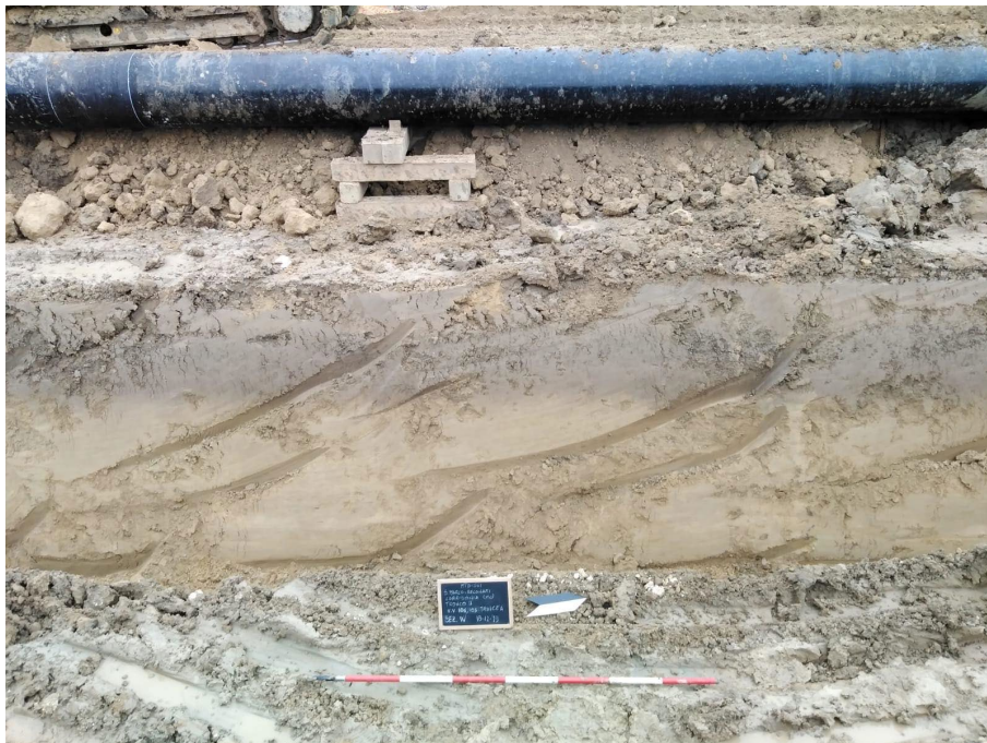
4.11 – Particolare dell'asse scavo. Sezione W e vista E del vertice di cantiere 106-107 / tronco II.
