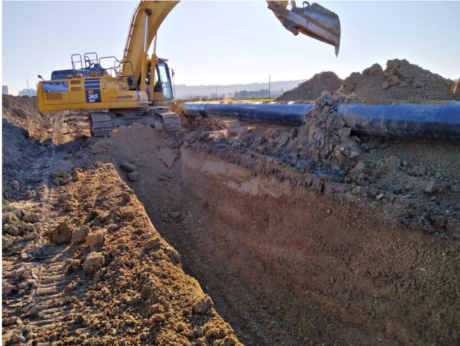
4.7– Asse scavo, foto d'insieme - vista SW in direzione Fiume Chienti del vertice di cantiere 104 – 103 / tronco II.
