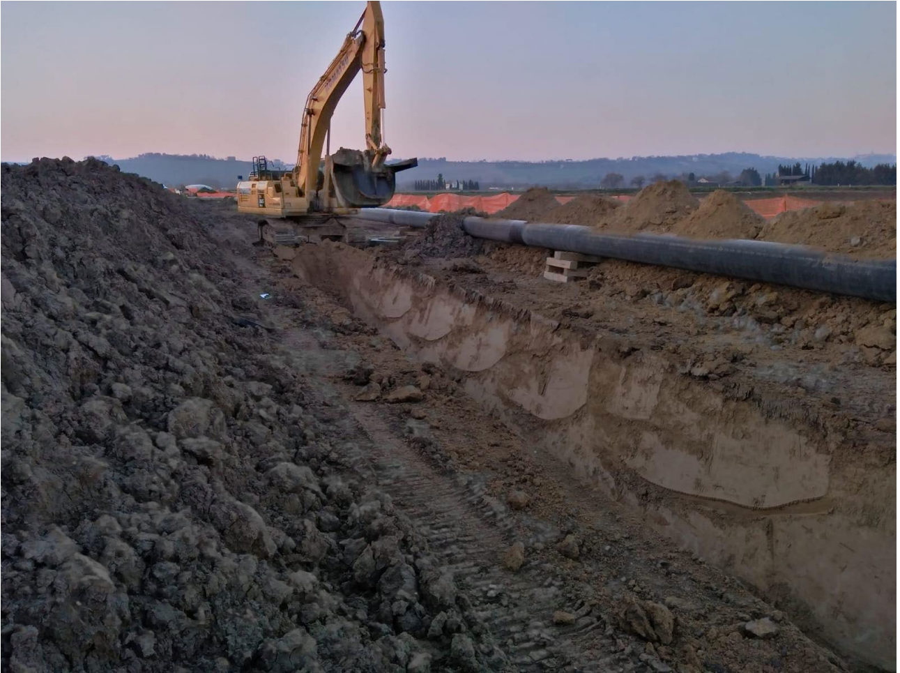
Fig. 4.2 – Foto generale durante lo sbancamento in asse scavo per la posa del tubo MTD SGI San Marco – Recanati.
