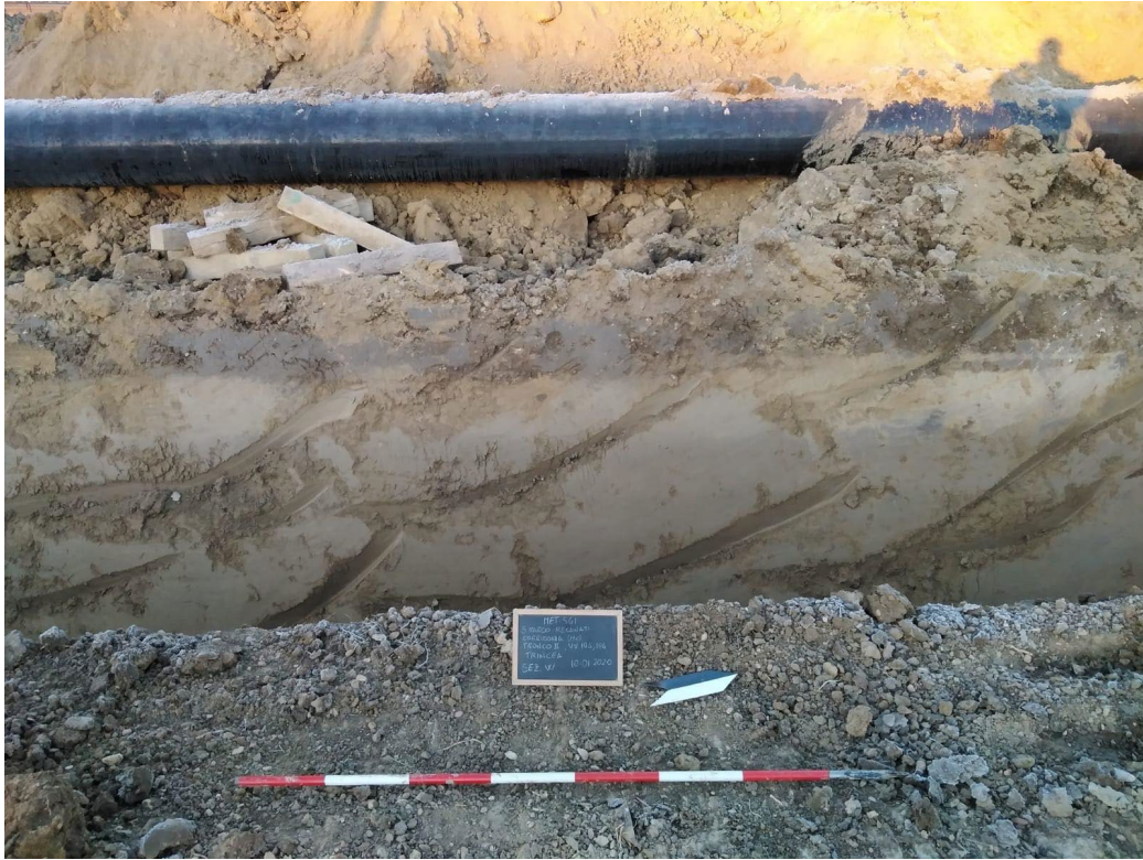
4.5 – Particolare dell'asse scavo. Sezione e vista SE del vertice di cantiere 104 / tronco II.
