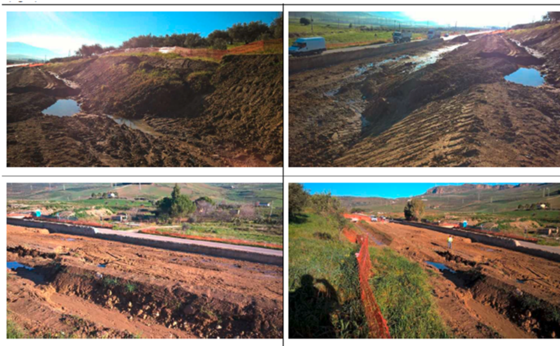
Figura 1 Esempio delle criticità emerse durante gli sbancamenti preliminari per la realizzazione dell’opera
