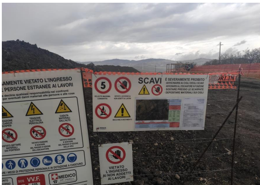
Fig. 1 – Cartellonistica di cantiere installata in corrispondenza degli accessi alle aree di lavoro
