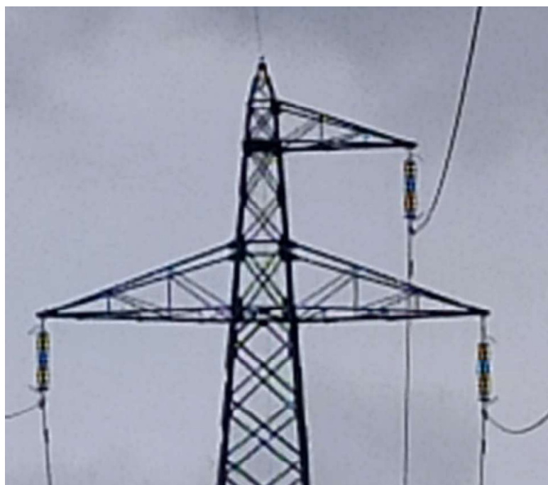
Foto 1: testa del sostegno n. 60 della linea n. 837, che si trova a nord-est dell'edificio indagato. Armamento dei conduttori in sospensione.
