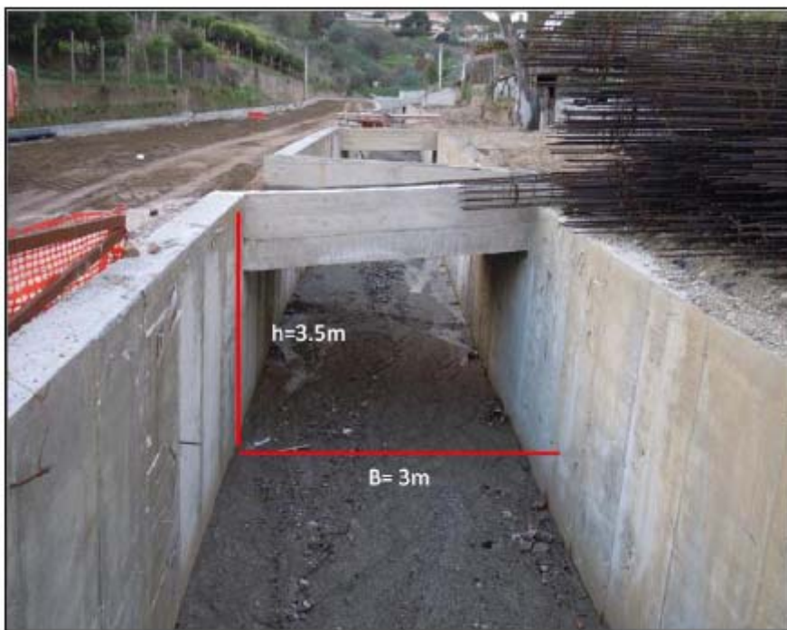
Foto n° 9: Torrente Curcuraci: Lavori di canalizzazione zona a monte della stazione di sollevamento (Manufatto M4_Cu)
