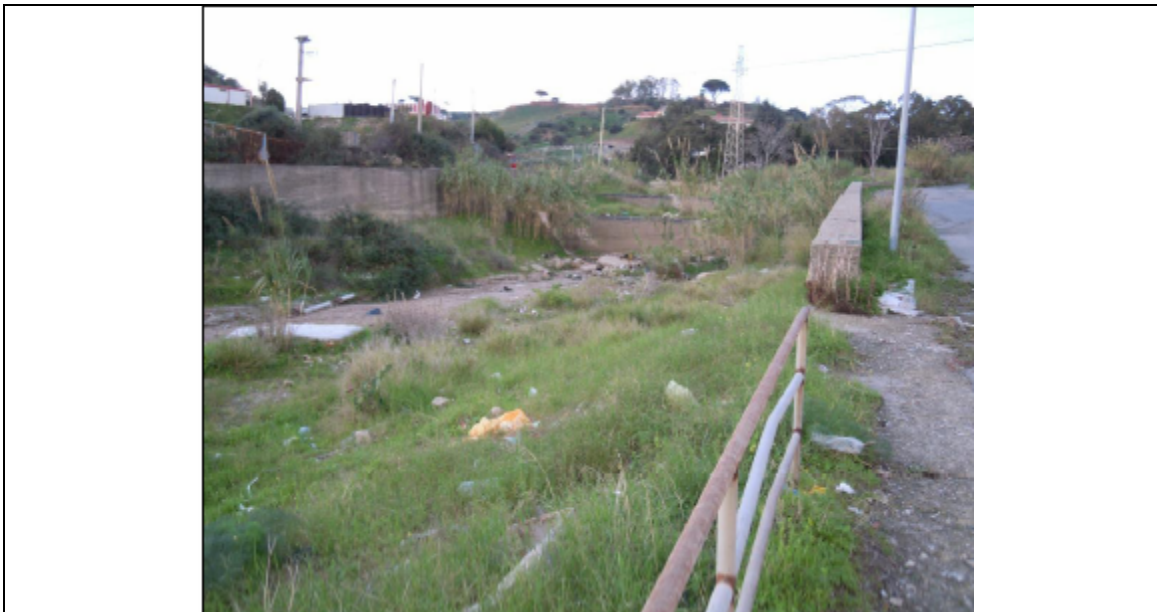
Foto n° 19: Vista da valle dei salti di fondo e delle briglie nel tratto a valle della confluenza tra il T. Guardia da destra ed il T. Curcuraci da sinistra.
