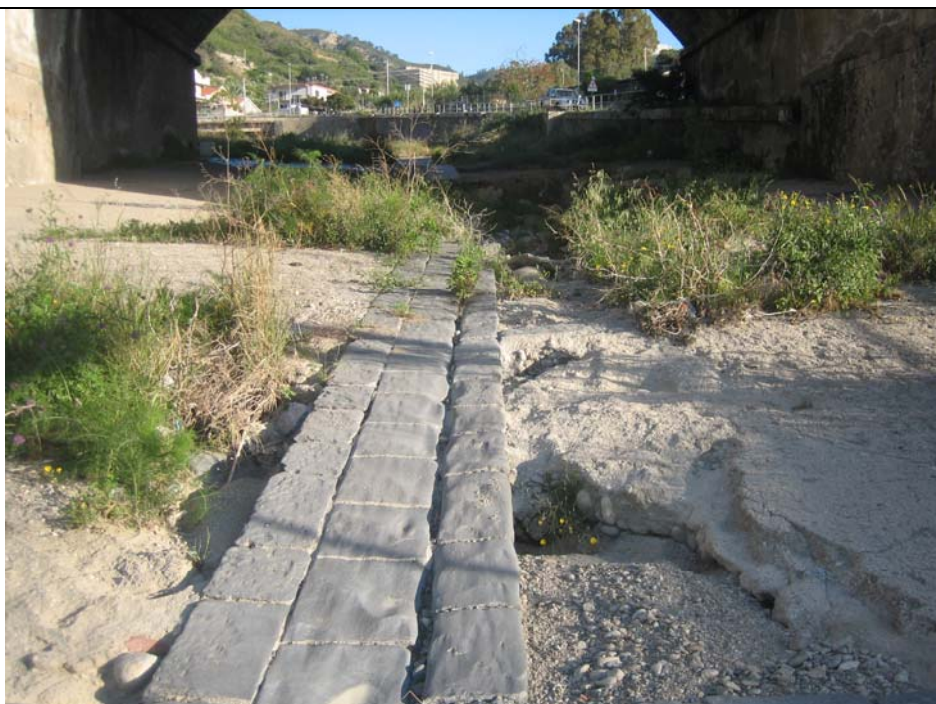
Foto n° 8: Torrente Pace: erosioni del fondo alveo originariamente rivestito in calcestruzzo nel tratto a valle del ponte ad arcate P1_P: arcata centrale
