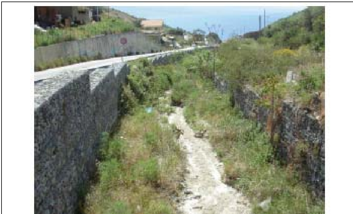
Foto n° 14: Torrente Pace: Tratto canalizzato tra pareti in gabbioni fra i manufatti M7_P e M8_P
