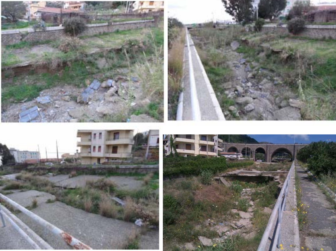
Foto n° 6: Torrente Pace: erosioni del fondo alveo originariamente rivestito in calcestruzzo nel tratto a monte del salto S1_P al ponte ad arcate P1_P
