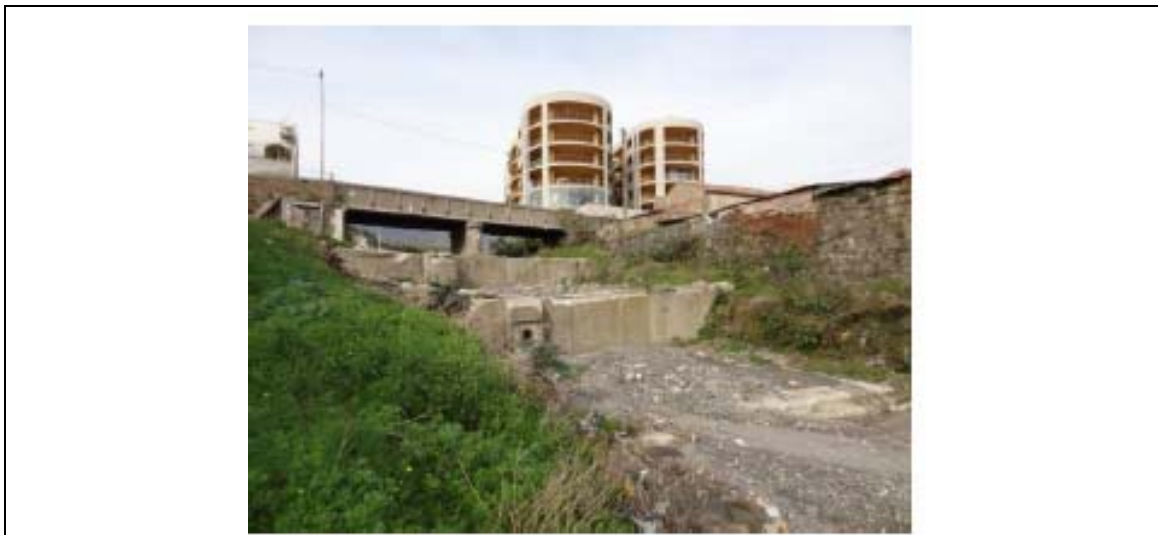
Foto n° 7: Torrente San Filippo: Manufatto P6_SF e salti di fondo, vista dal valle
