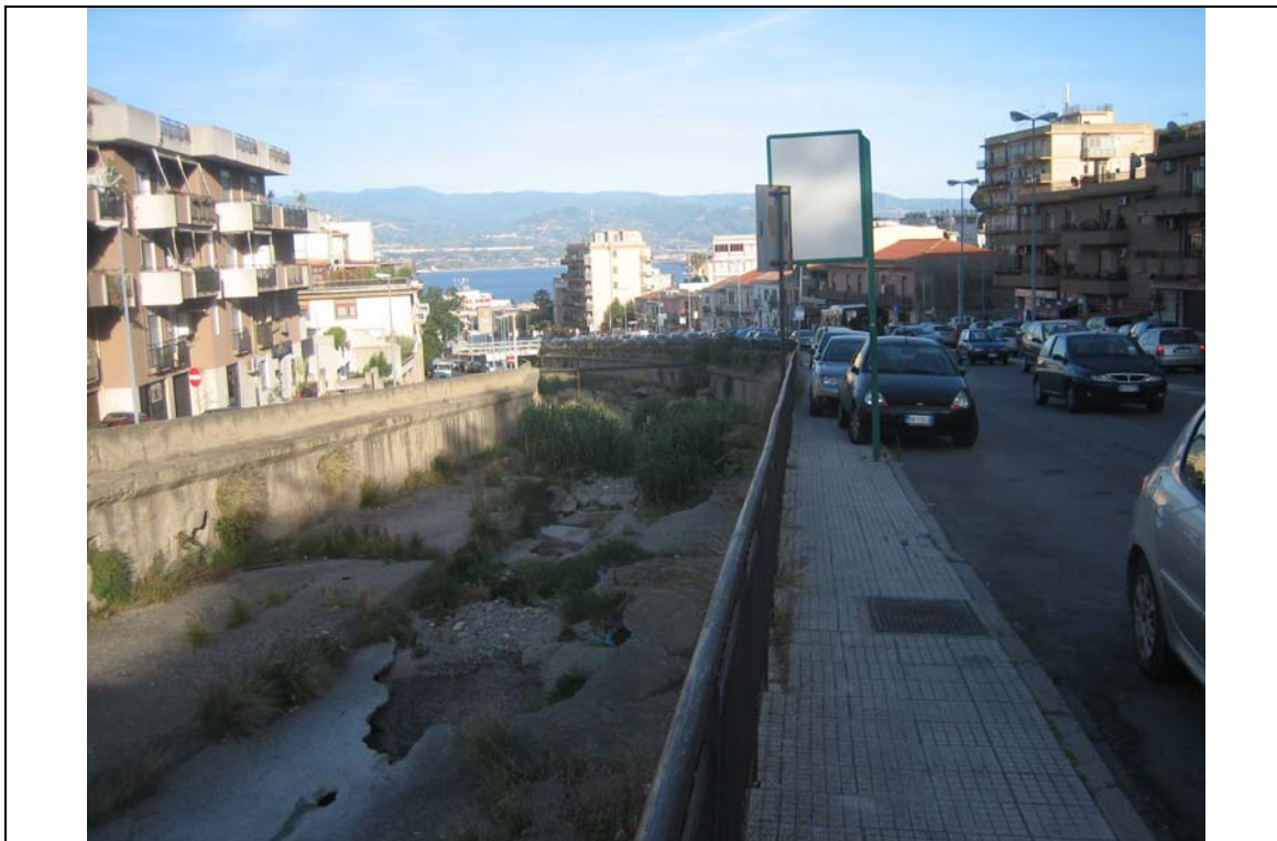
Foto n° 7: Torrente Annunziata: Fondo alveo dissestato a monte del manufatto M10_A
