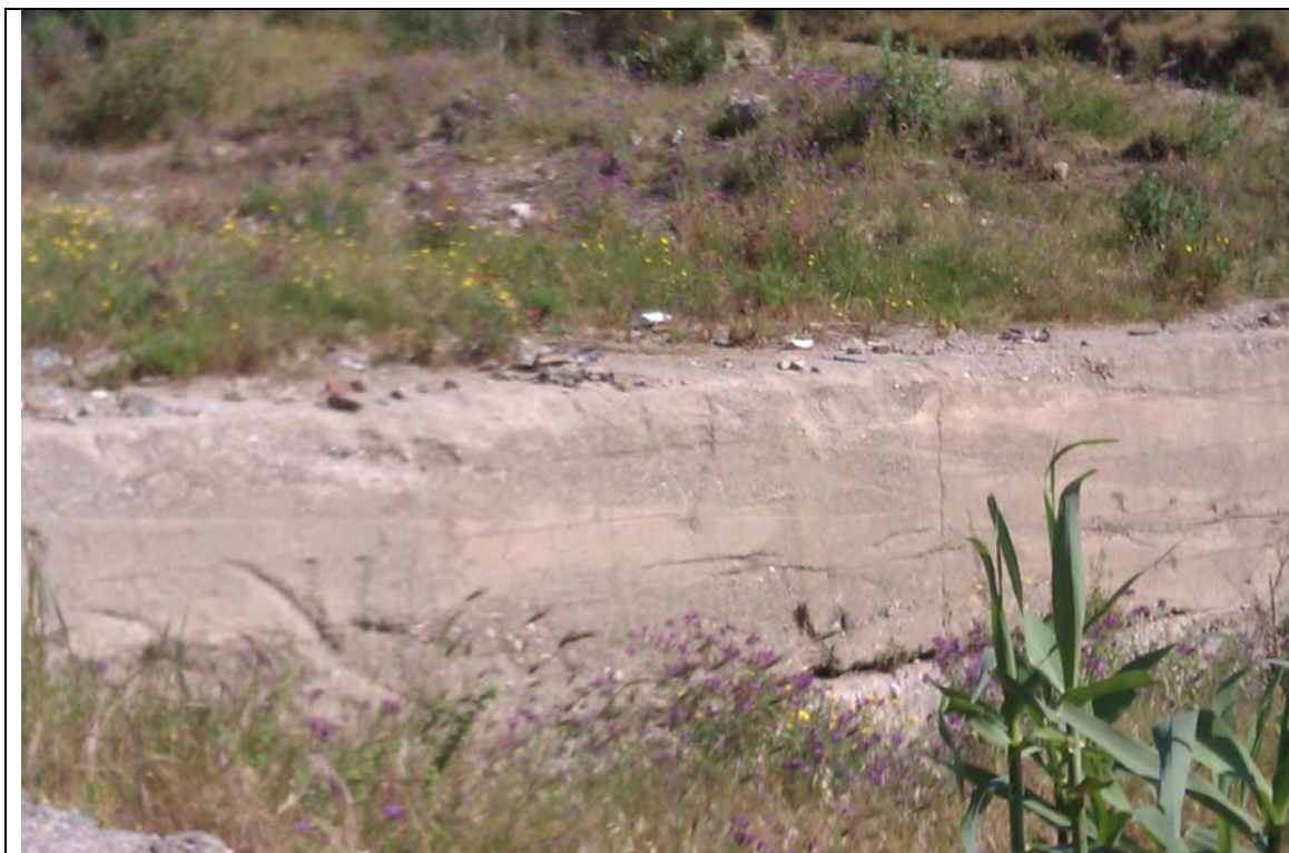
Foto n° 20: Vista da valle del salto di fondo immediatamente a valle della confluenza tra il T. Guardia da destra ed il T. Curcuraci da sinistra
