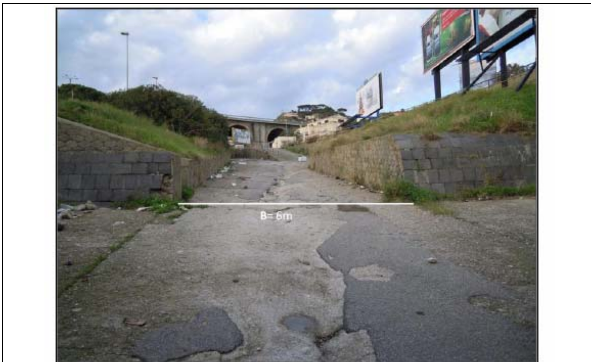
Foto n° 5: Vista da valle del restringimento della sezione del corso d'acqua a monte del manufatto M0-G.
