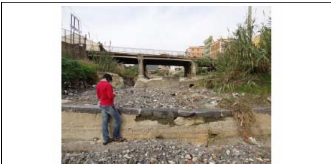
Foto n° 6: Torrente San Filippo: Manufatto P7_SF e salti di fondo, vista dal valle
