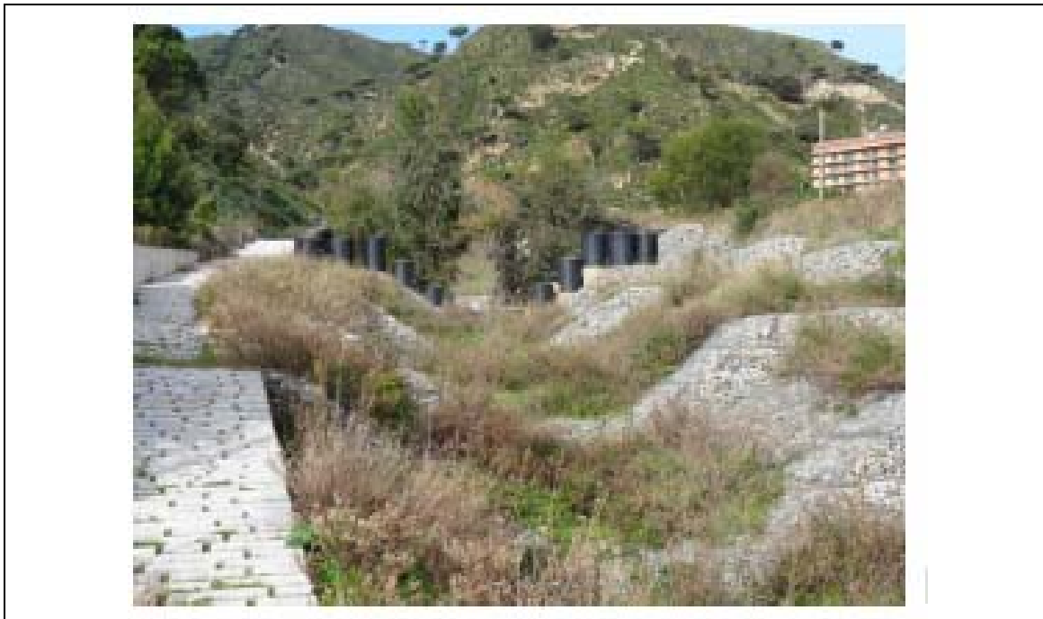
Foto n° 25: Torrente Ciccia: Vasca sghiaiatrice M18_A
