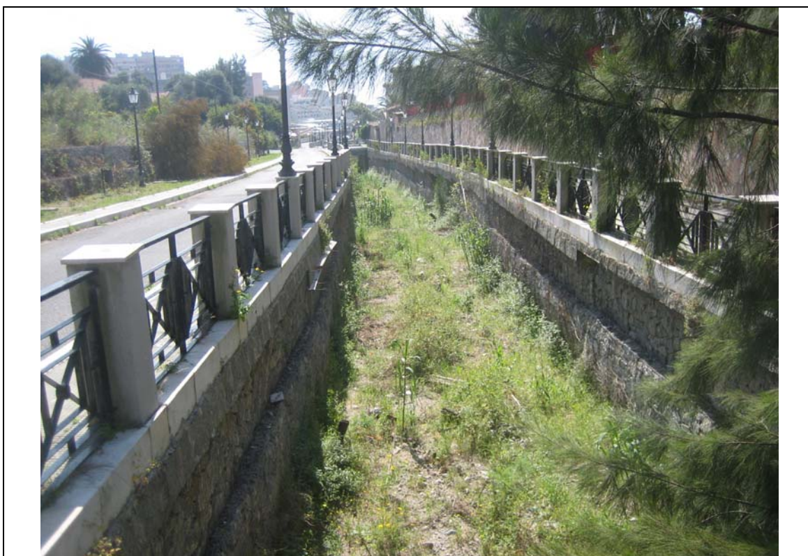
Foto n° 16: Torrente Ciaramita: tratto alveo a monte dal manufatto T2_A vista da monte
