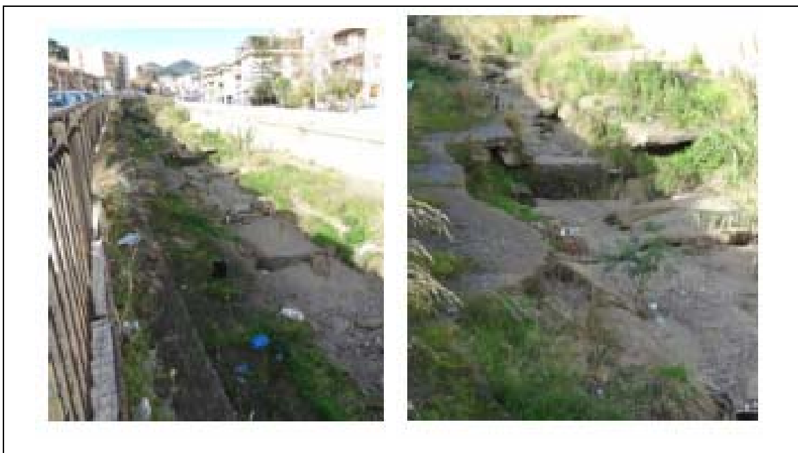
Foto n° 6: Torrente Annunziata: Fondo alveo dissestato a monte del manufatto M10_A
