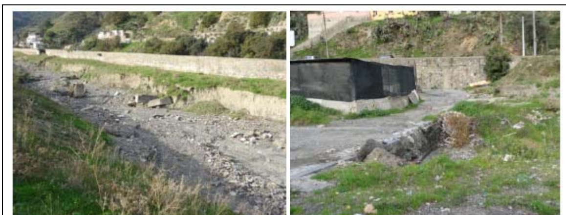
Foto n° 26: Torrente San Filippo: Tratto a monte dello svincolo autostradale: Erosione spondale e guado G1_SF
