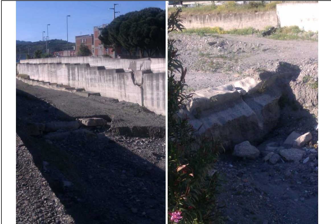
Foto n° 15: Torrente San Filippo: dissesti su muro d'argine in sinistra e su salti di fondo
