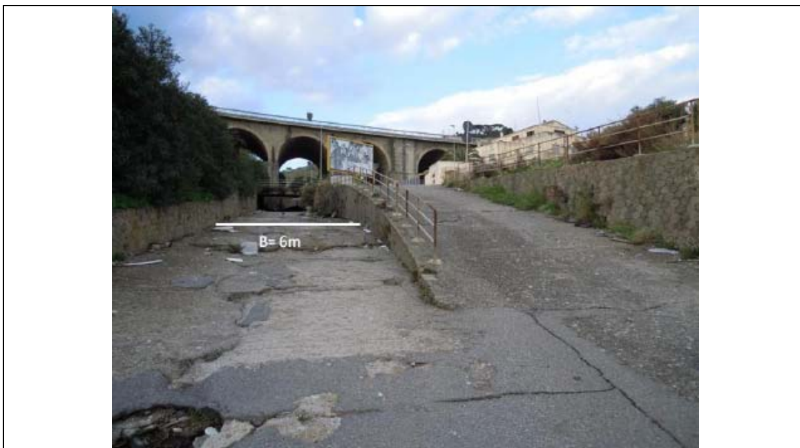
Foto n° 7: Vista da valle del restringimento della sezione del corso d'acqua a monte del manufatto M0-G.
