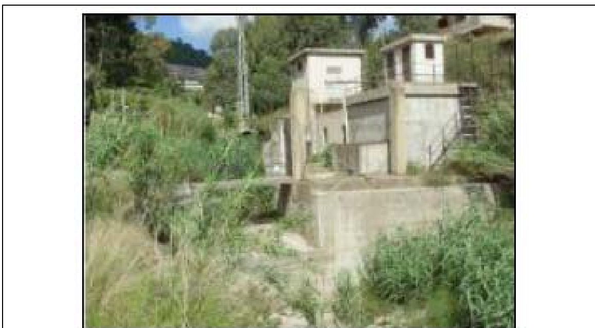
Foto n° 8: Torrente Curcuraci: stazione di sollevamento a monte M3_Cu
