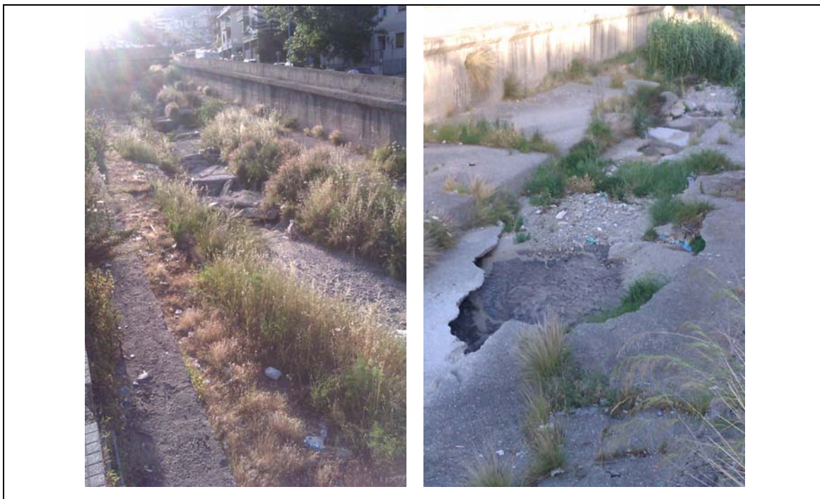
Foto n° 5: Torrente Annunziata: Fondo alveo dissestato a monte del manufatto M10_A
