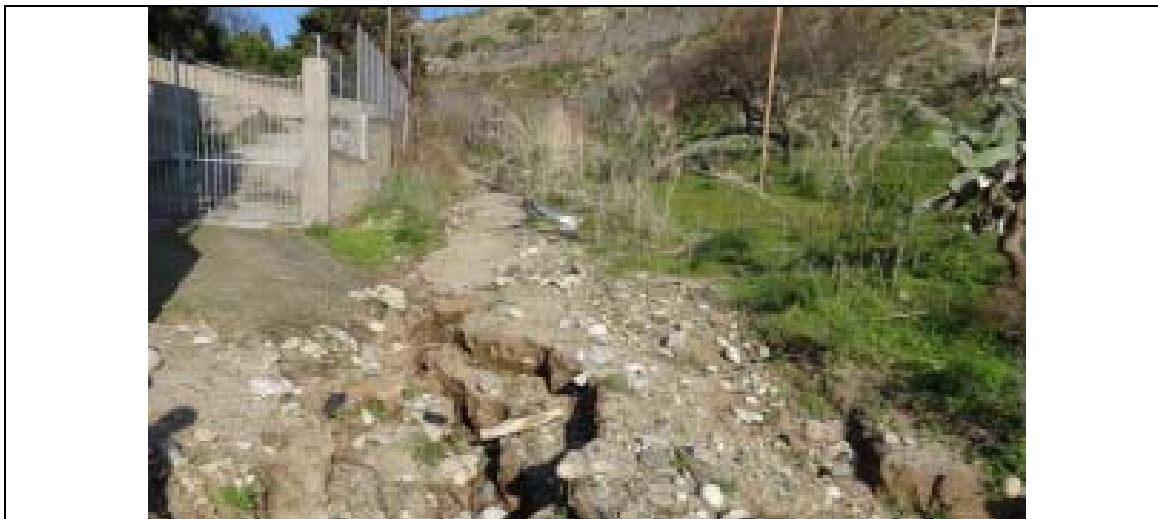
Foto n° 24: tratto d'alveo a monte della confluenza con erosione sul fondo, vista da valle
