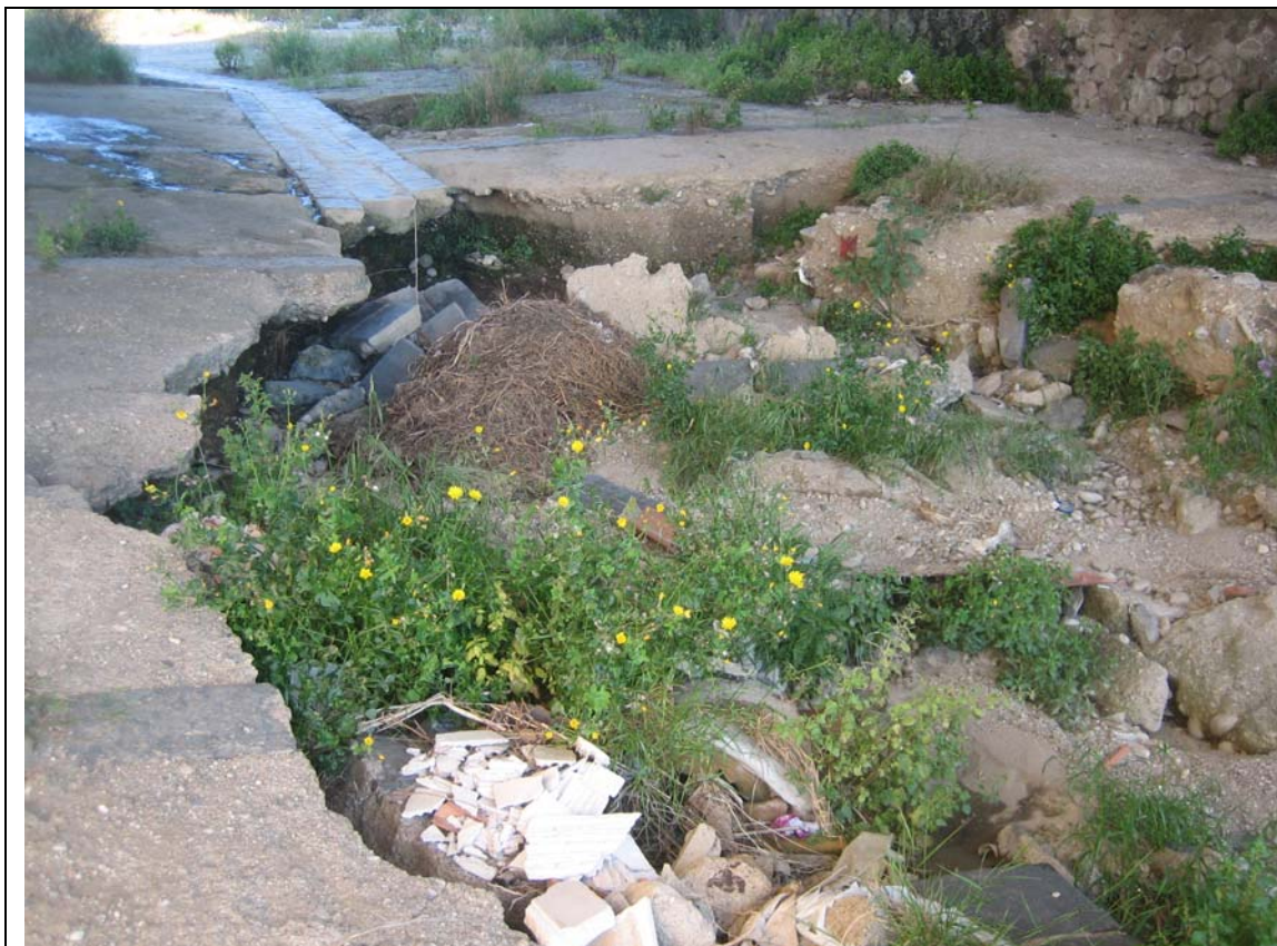
Foto n° 9: Torrente Pace: erosioni del fondo alveo originariamente rivestito in calcestruzzo nel tratto a valle del ponte ad arcate P1_P: arcata centrale
