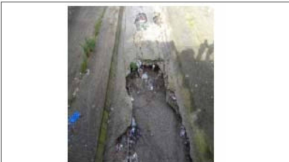
Foto n° 12: Torrente Annunziata: Particolare di dissesto per sifonamenti del fondo alveo di magra in calcestruzzo
