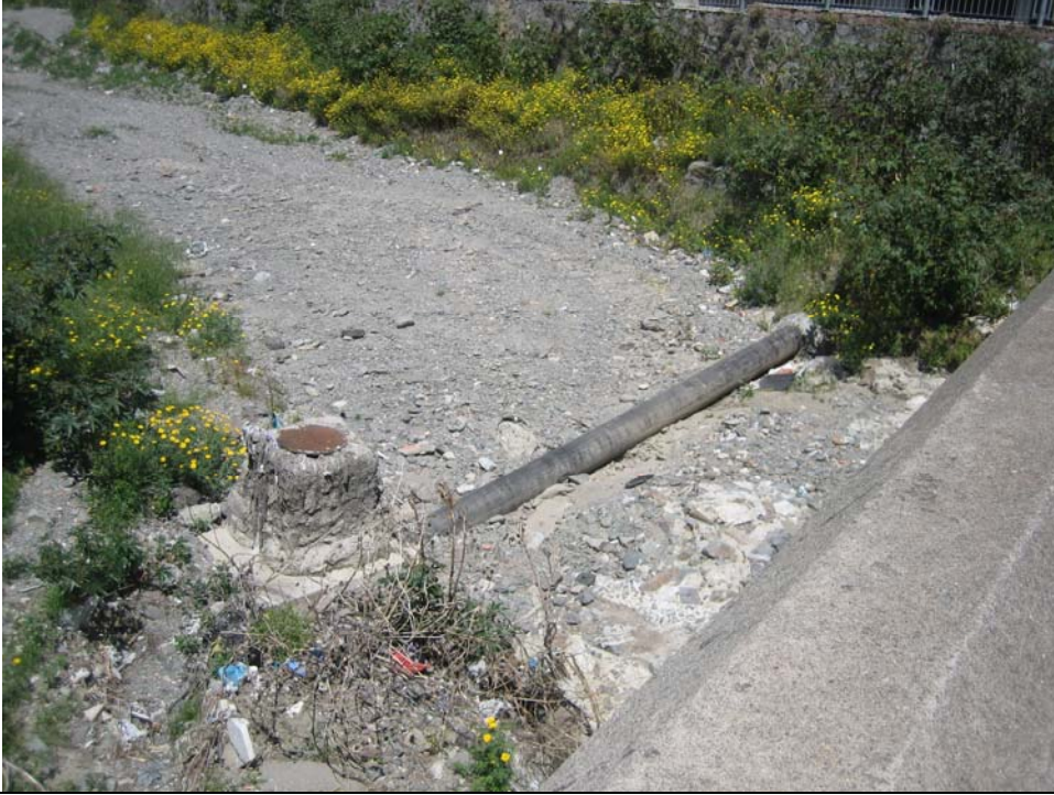
Foto n° 9: Torrente San Filippo: Tubazione in alveo a monte P6_SF (ex SS114)
