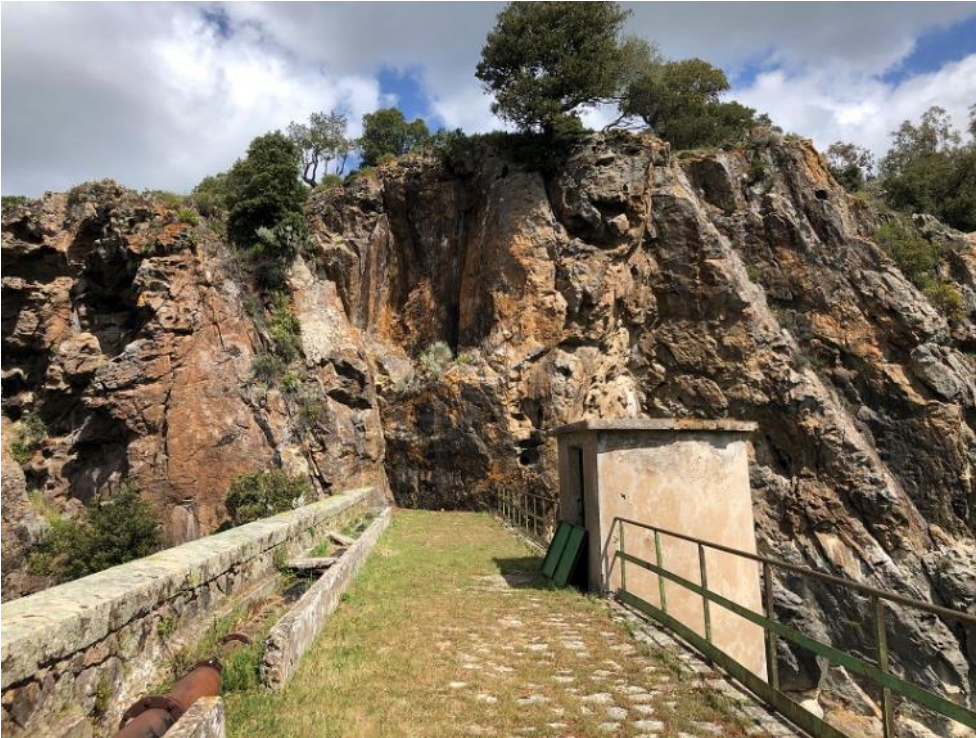
Figura 22 : Vista panoramica - Pareti fortemente fratturate sponda imposta diga
