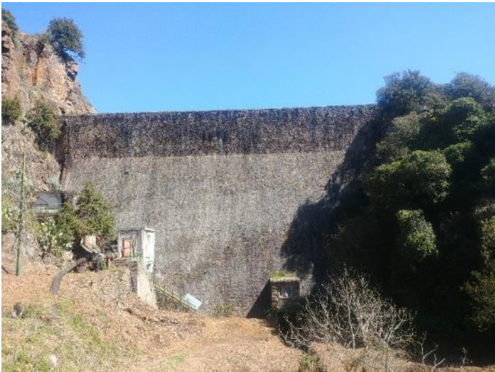
Figura 13: Vista del paramento di valle e dello scarico di fondo della diga Bunnari Basso
