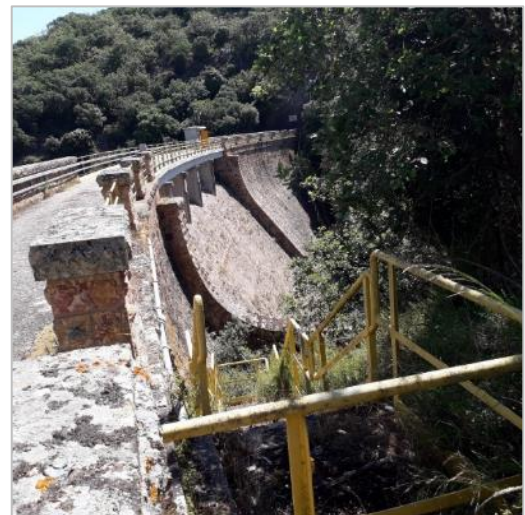
Figura 14: Vista del paramento di valle e degli organi di sfioro della diga Bunnari Alto
