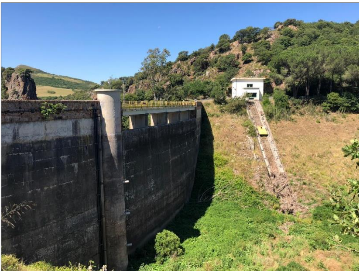
Figura 2 : Ripresa della torretta di presa di Bunnari Alto, da cui sono visibili n°3 delle complessive n°4 bocche di derivazione dell'acqua
