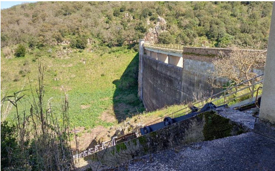
Figura 19 : Diga di Bunnari Alta – Vista da monte della diga con paratoia piana (in primo piano) e torrino di presa
