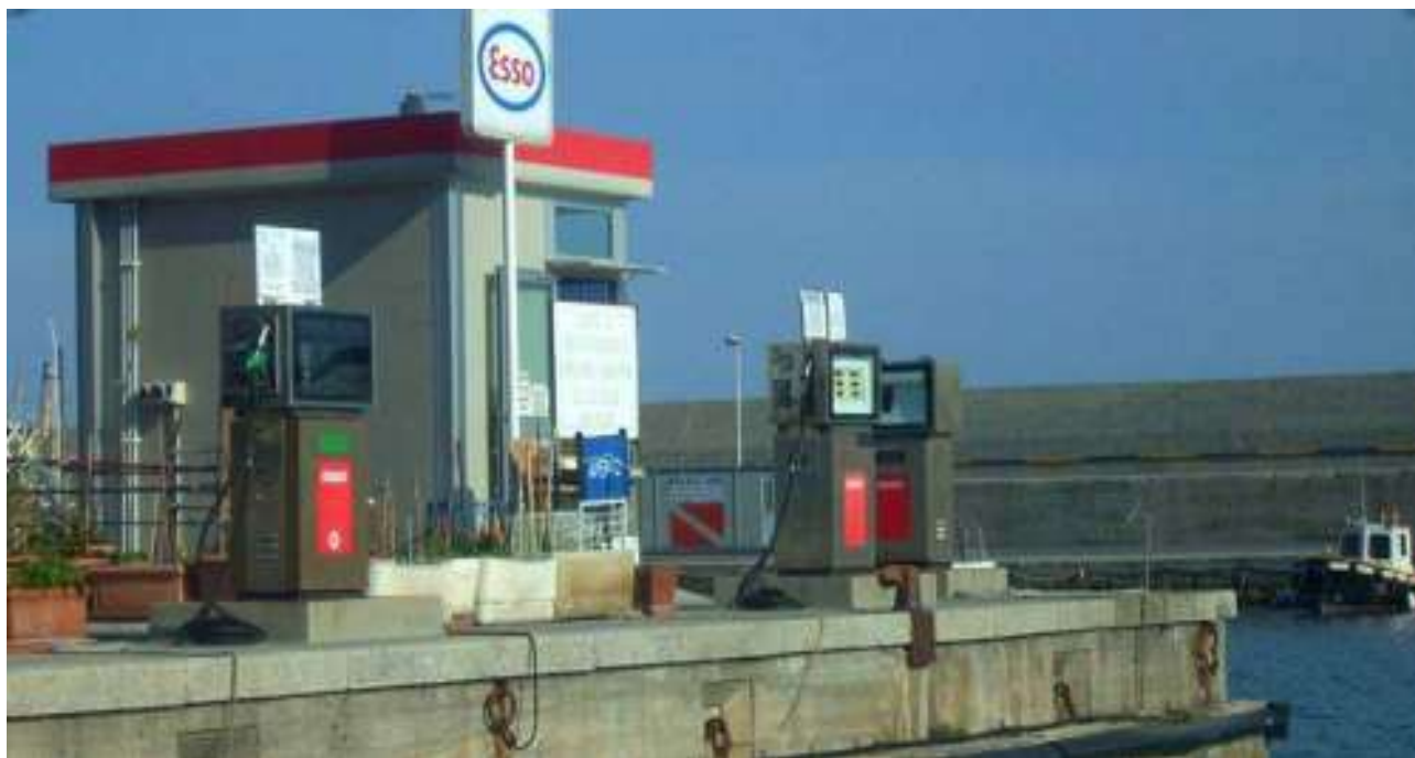
Distributore carburante, posto sulla testata del molo di sottoflutto
