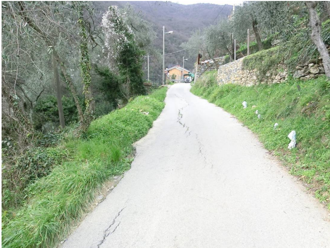
Figura 43 - Lesioni nell'asfalto lungo la strada comunale al si sopra dell'A12
