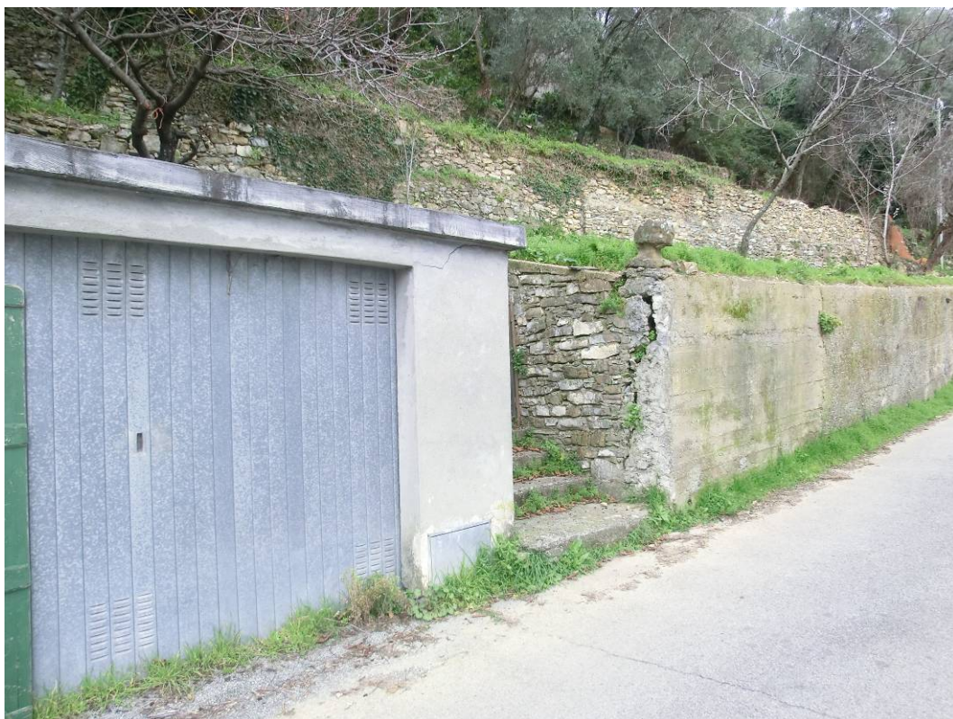
Figura 44 - Lesioni lungo la strada comunale al si sopra dell'A12
