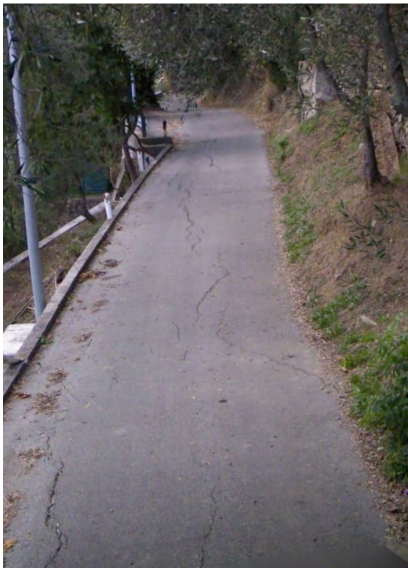
Figura 48 - Lesioni lungo la strada di Arbocò
