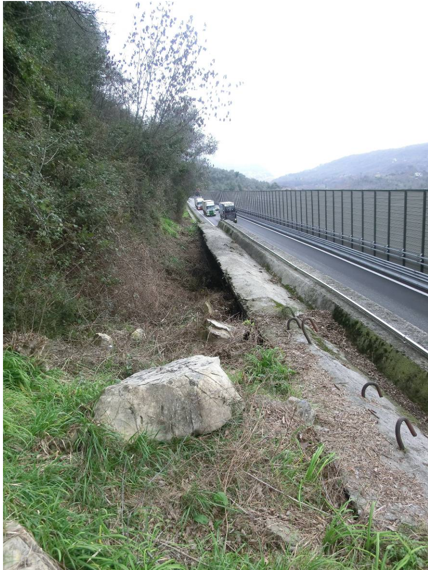
Figura 42 - Scavernamento dietro il muro di controripa
