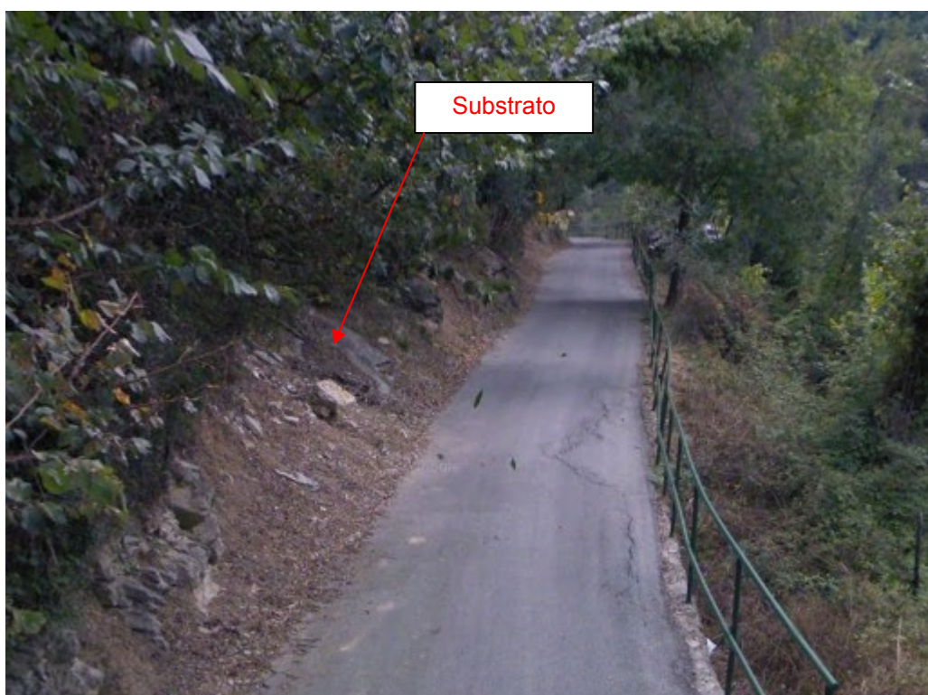
Figura 47 - Lesioni lungo la strada di Arbocò
