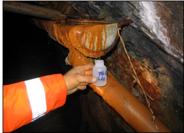
Foto 2 - Punto di prelievo alla progressiva km 0+716 della galleria dell'acquedotto in corrispondenza di abbondante residuo ferroso depositato dalle acque.
