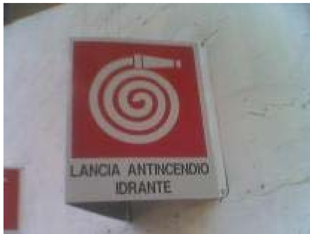
Figura 3 – Esempio di installazione a parete del cartello di segnalazione presenza cassetta idrante
