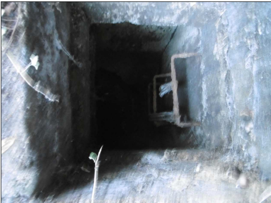
Foto 8: dettaglio pozzetto di accesso al tombino con scala a muro (zona Caserma Gavoglio)
