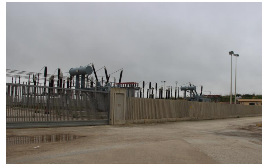
Figura 11 – Stazione Elettrica SE RTN “Sambuca” all'interno della quale è prevista la realizzazione dello stallo arrivo cavo AT
