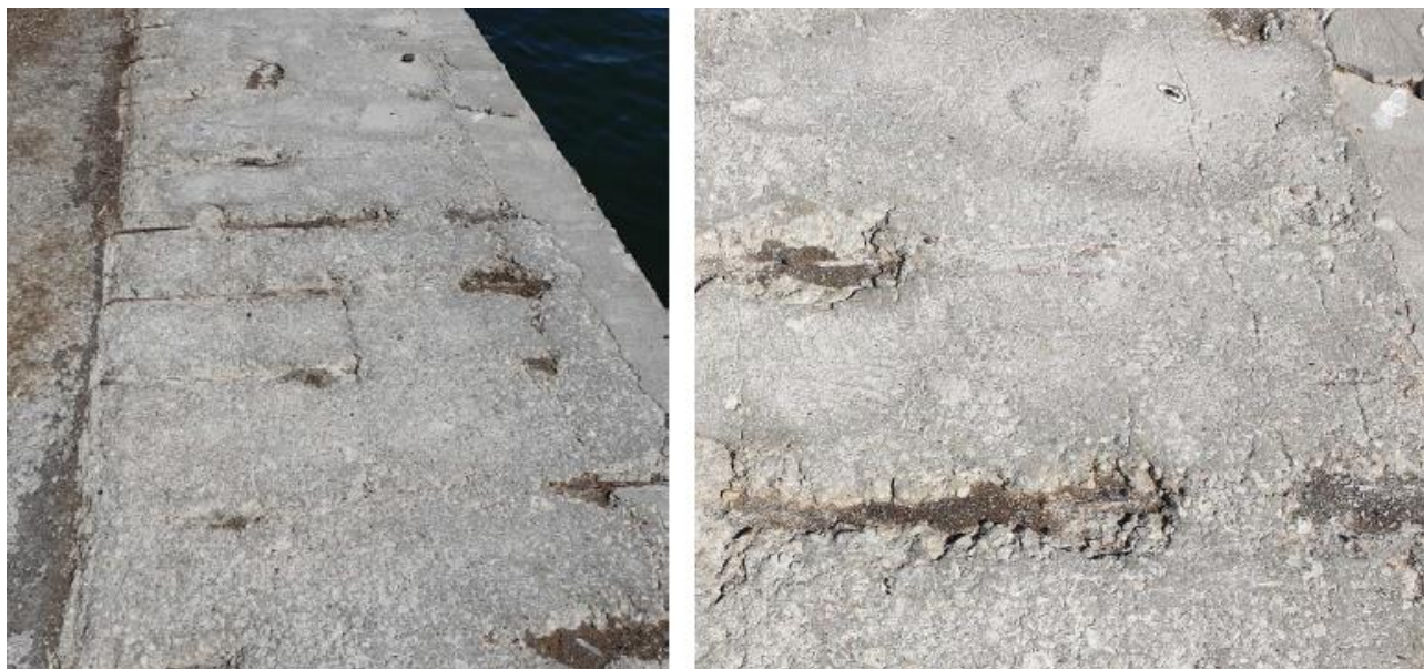
Figura 15 - Trave di banchina - sgrottamenti ed armature esposte
