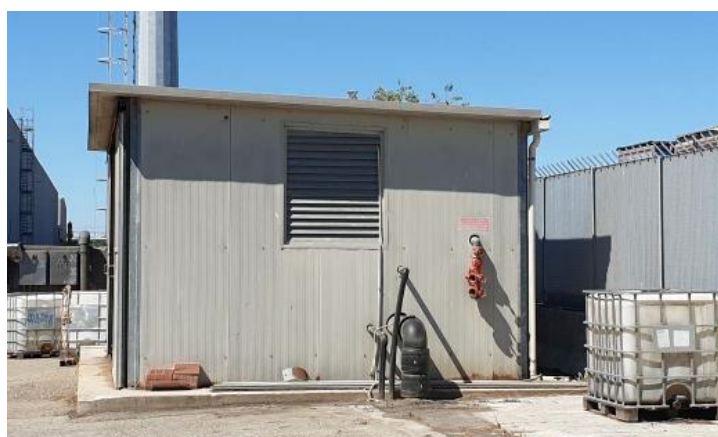
Figura 24 - Centrale di spinta impianto antincendio esistente
