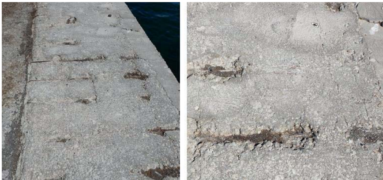
Figura 14 - Trave di banchina - sgrottamenti ed armature esposte
