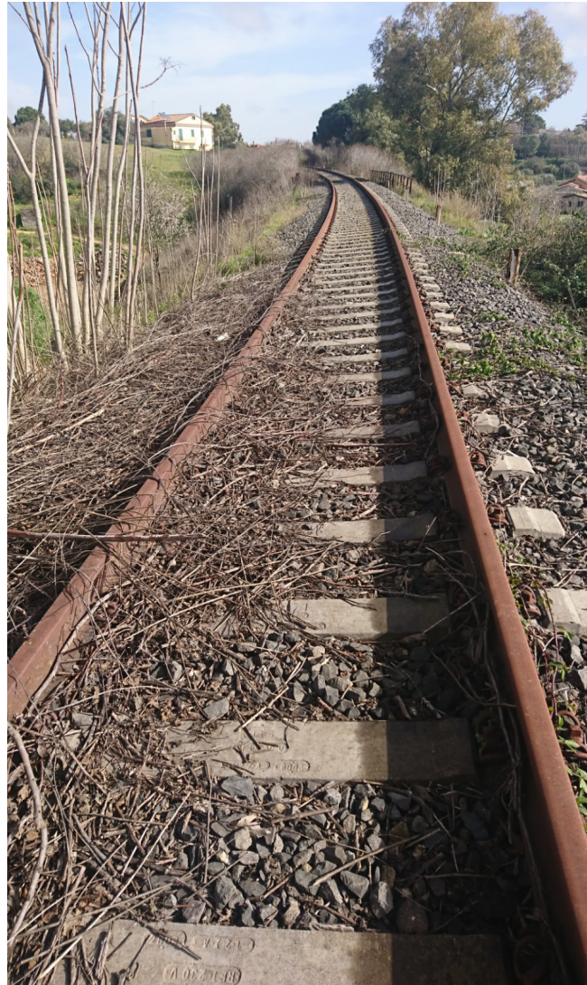
Figura 2.4 Attuale armamento sulla linea
