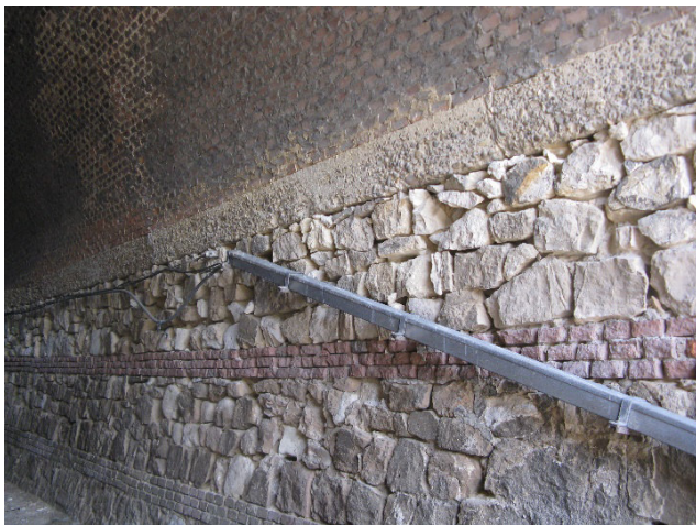
Figura 12: Malta assente o degradata tra i vari elementi dei rivestimenti
