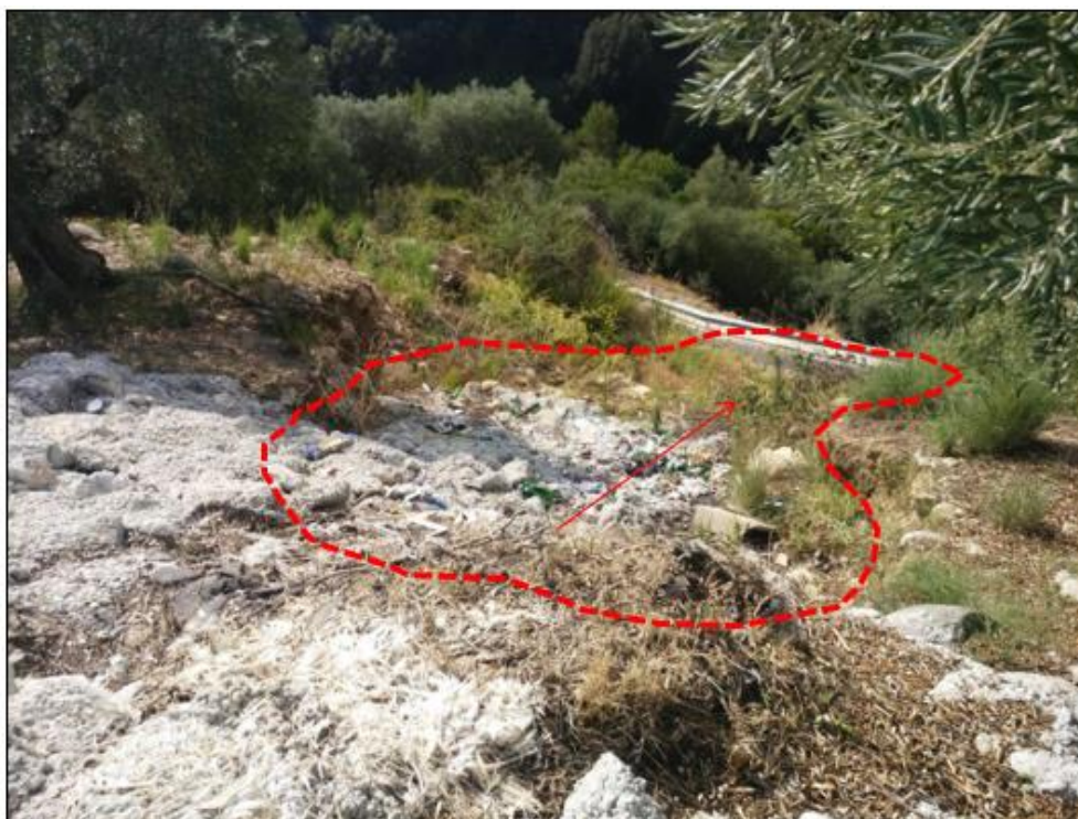
Figura 4 – Zona di coronamento di una frana che ha intercettato un tornante della SP32, a monte di Ponte Coniglio, in un'area di scarpata caratterizzata da notevole altezza che la delimita dalle Gole del Neto.
