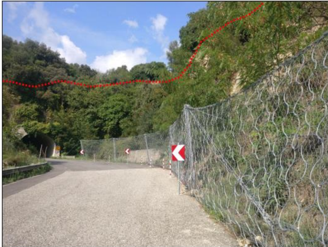
Figura 6 - Scarpata subverticale, interessata da crolli (in rosso il ciglio sommitale).
