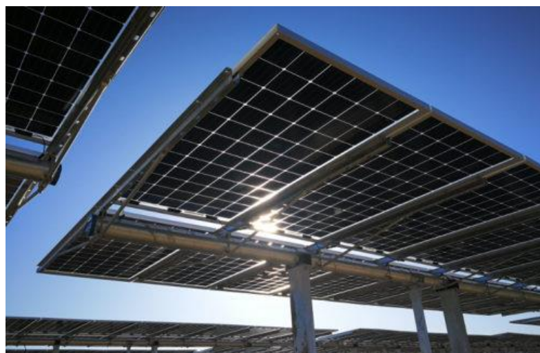
Figura 4.5 Esempio di struttura a tracker monoassiale
