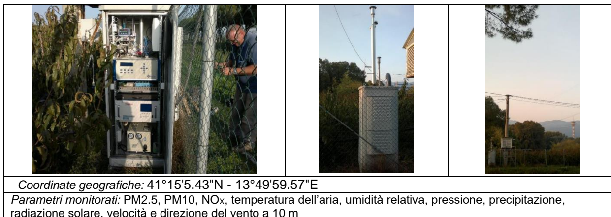
Figura 4-1 Cabina di monitoraggio
