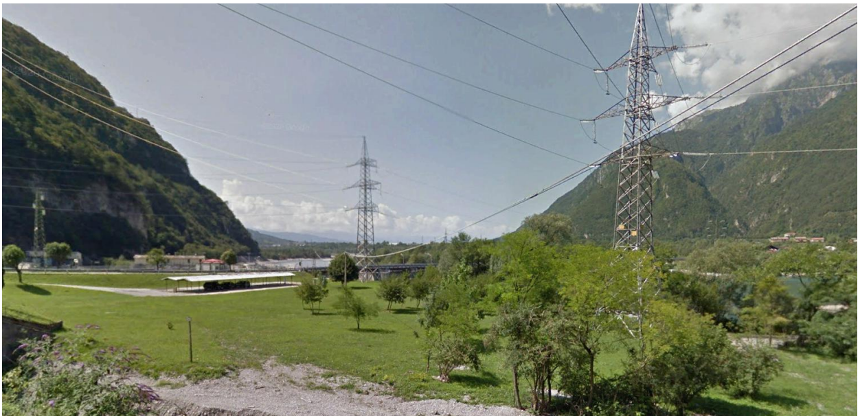
Soverzene – linee elettriche in uscita dalla Stazione di produzione
