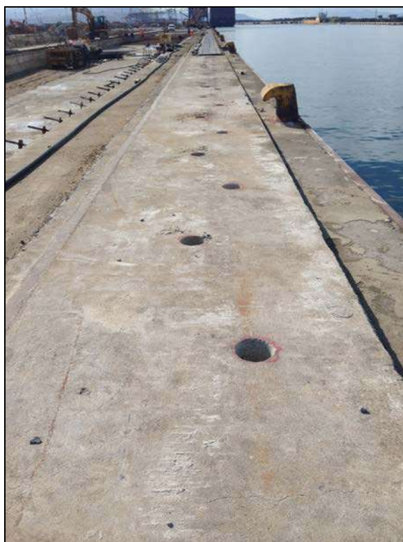
Foto 9 - Lavori in corso nel tratto D: fori nella trave di coronamento per il getto di cls per il rinforzo strutturale dei diaframmi esistenti
