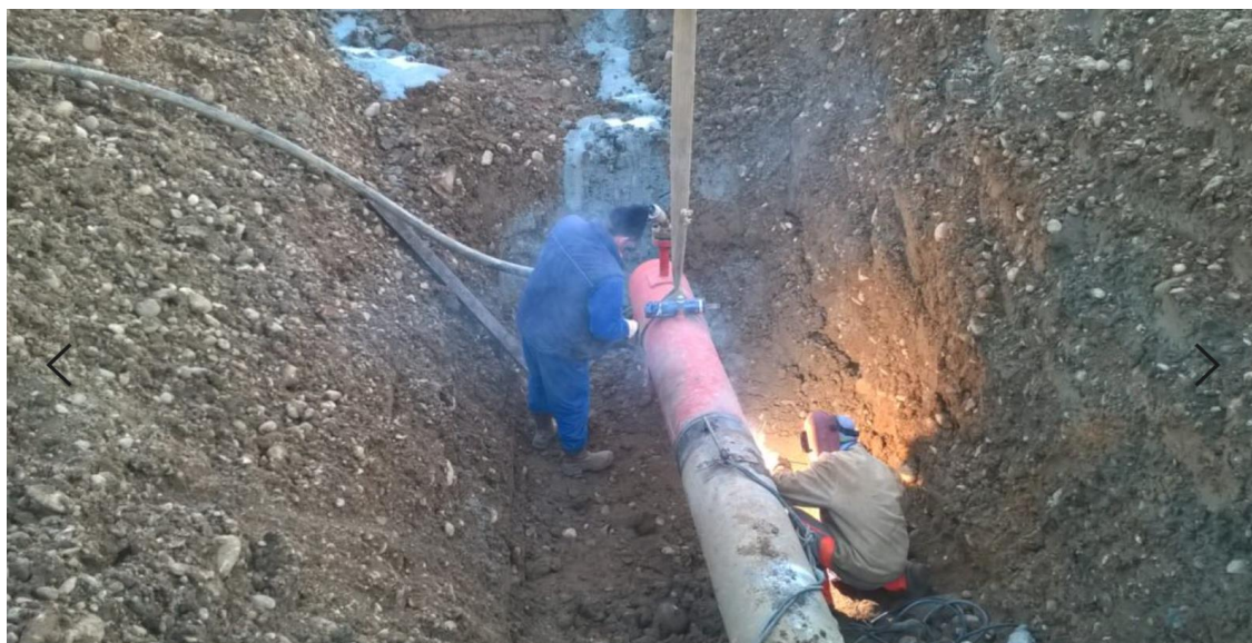
Foto 7.2.4/A – Sezionamento condotta
