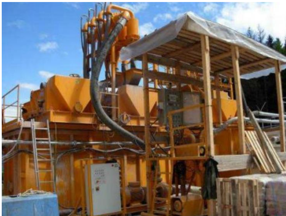
Foto 7.1.11/C - Sistema di disidratazione
