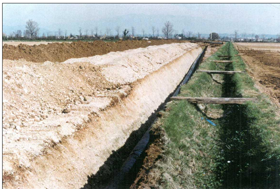
Foto 2.2/I: Tratto di condotta posata, si nota l'accantonamento dello strato humico separato dal materiale di scavo della trincea
