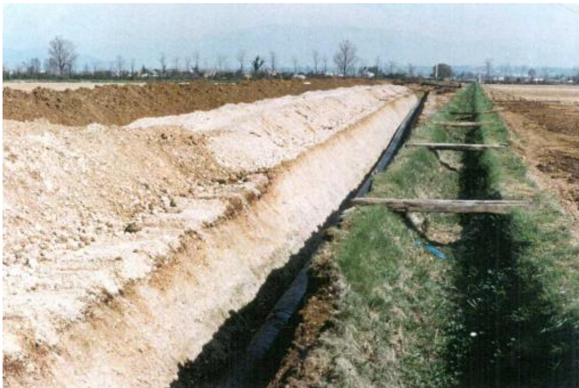
Foto 3.3.4.8/B - Tratto di condotta posata, con accantonamento dello strato humico separato dal materiale di scavo della trincea
