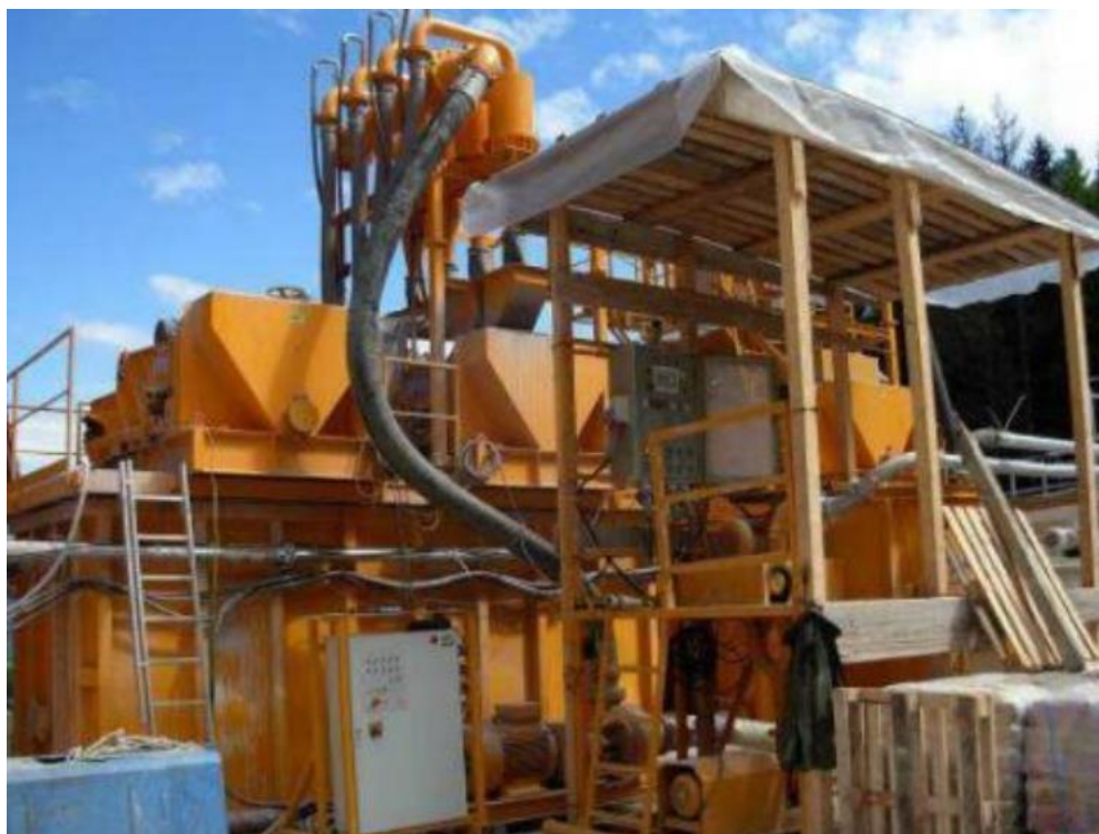
Foto 3.3.4.11/D - Sistema di disidratazione
