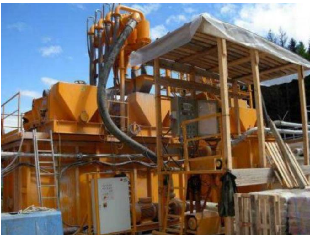
Fig. 4.2/G - Sistema di disidratazione
