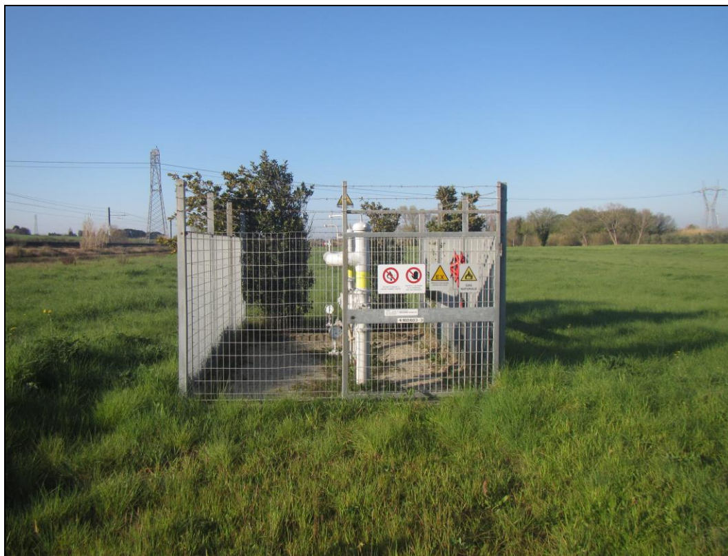
Fig.2.2: Foto impianto esistente PIL.4160603/3
