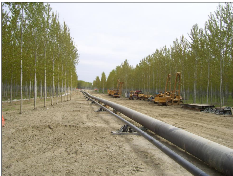
Attrav. F. Po con met. 30" – Colonna pipeline preassemblata sulla pista di varo
