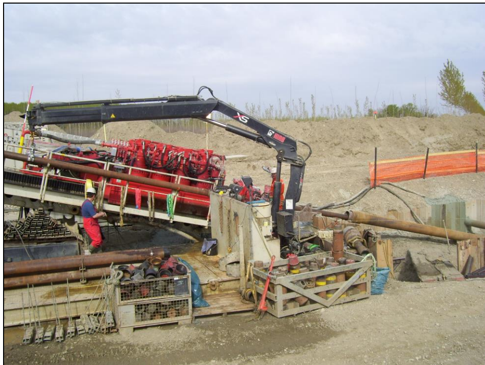
Attravers. F. Po con met. 30" – "Rig", durante la realizzazione del foro pilota
