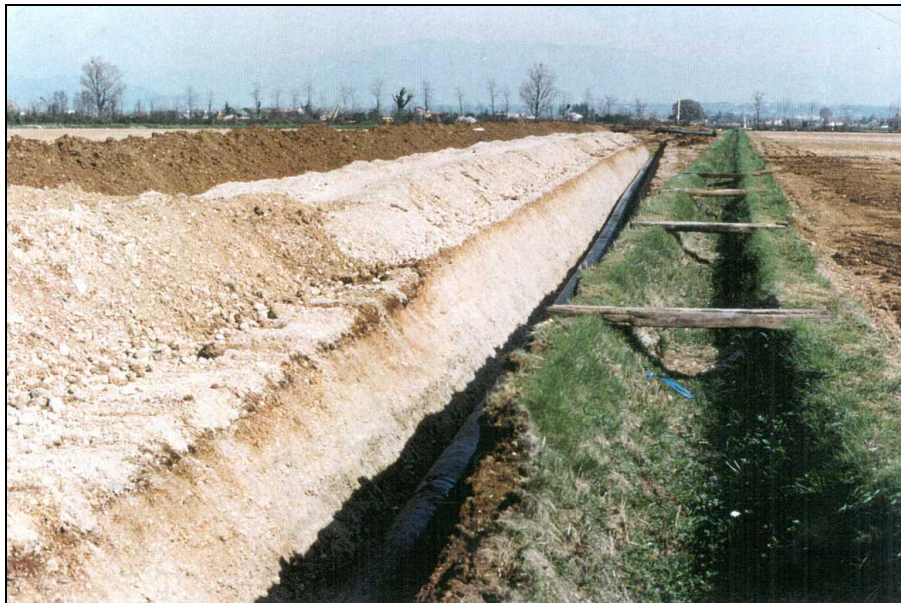
Foto 3-2/I: Tratto di condotta posata, si nota l'accantonamento dello strato humico separato dal materiale di scavo della trincea
