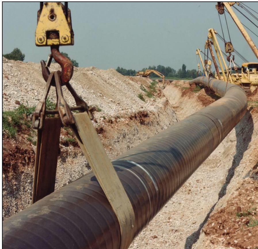
Foto 3.2/H: Posa della condotta (esempio di condotta con diametro superiore alla linea in progetto)
