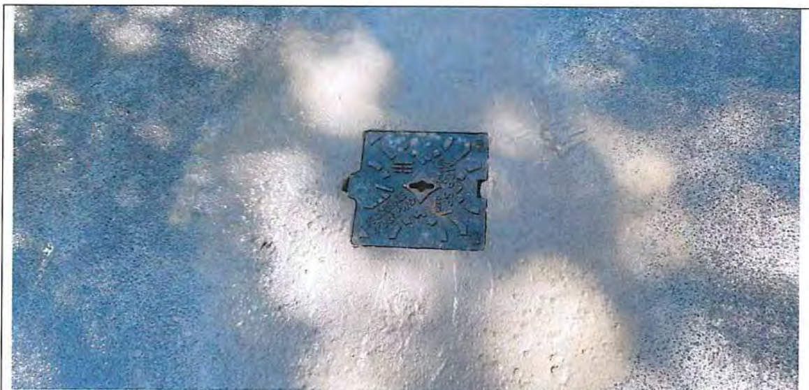
Chiusino di protezione per piezometro
