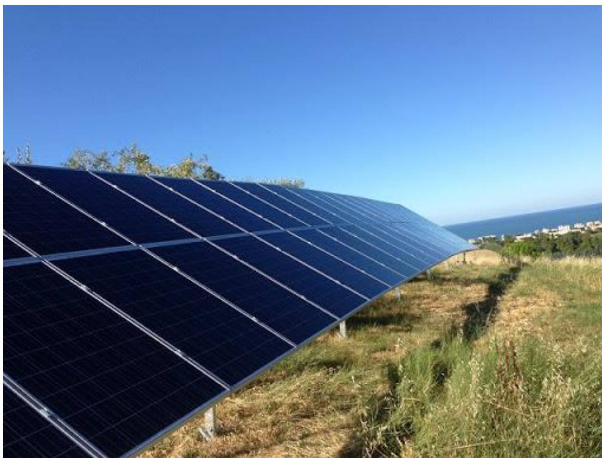
Figura 4.10: Esempio di Struttura di sostegno moduli fotovoltaici
