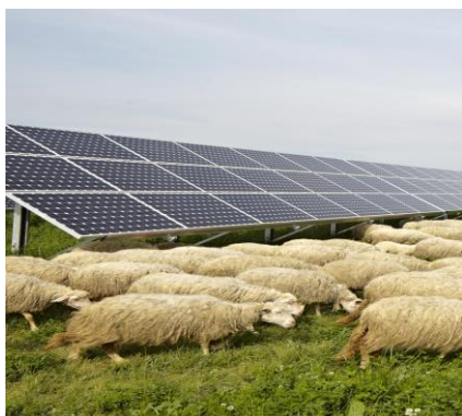
Ovini al pascolo "impianto FTV" Provincia di Ravenna
