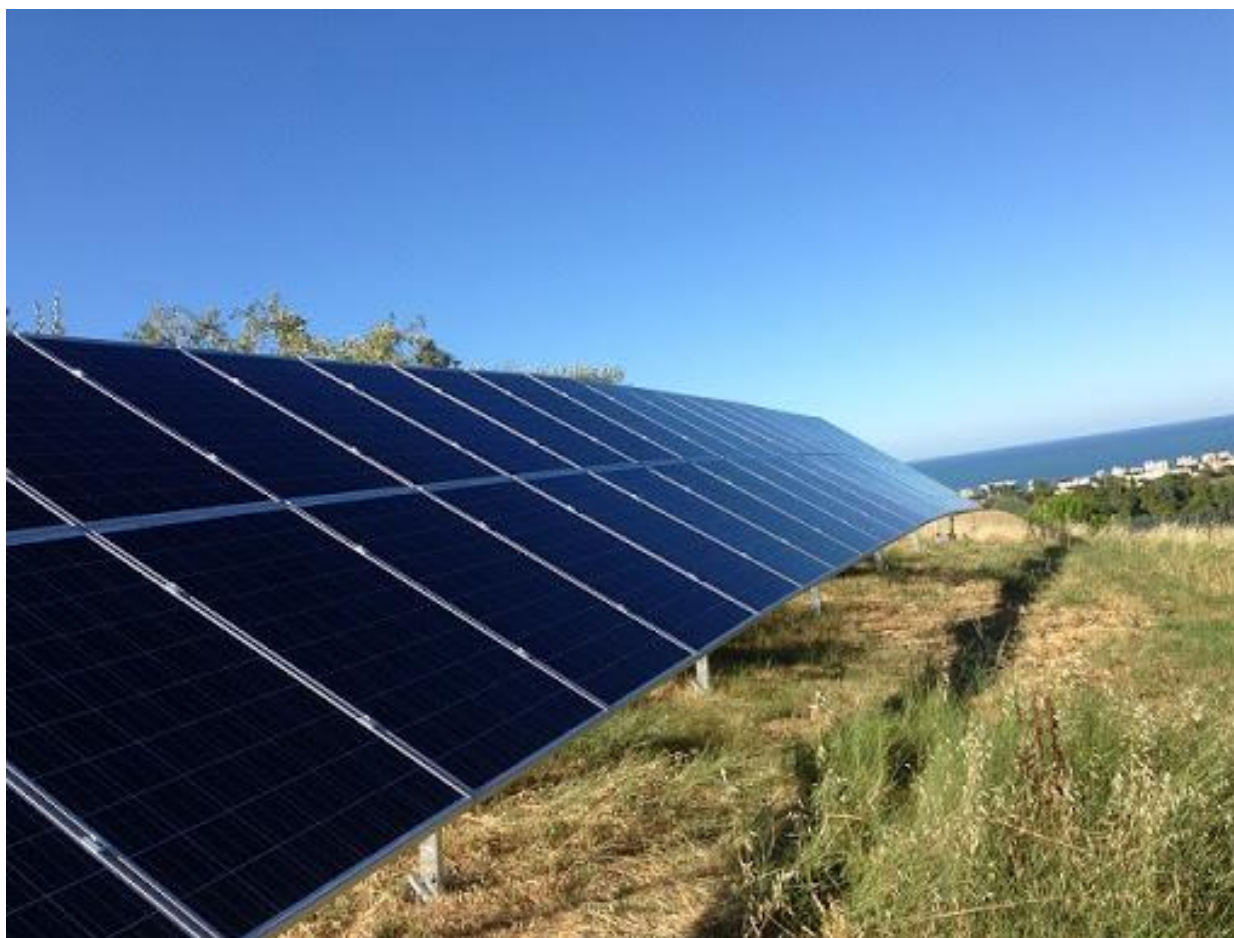
Figura 3.10: Esempio di Struttura di sostegno moduli fotovoltaici
