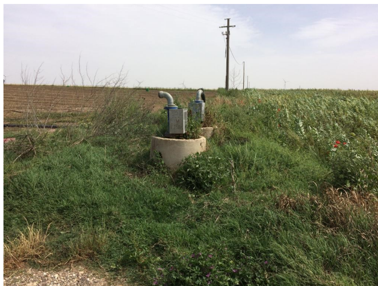
Foto 1 – Idranti presenti in prossimità del confine di proprietà
