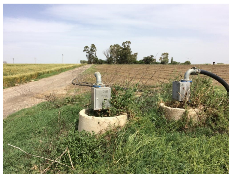
Foto 2 – Idranti presenti in prossimità del confine di proprietà
