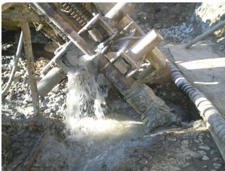
Figura 80 - Venuta d'acqua in pressione dal foro di sondaggio VB7 bis.
