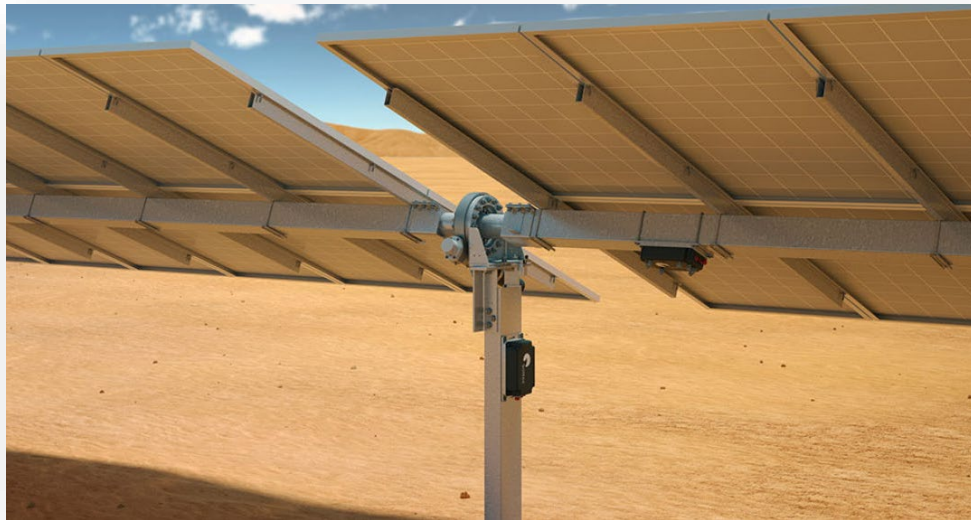
Figura 24- Vista sistema tracker
