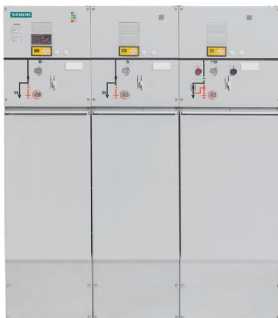
Figura 12 – Vista frontale quadro di protezione in media tensione della cabina di trasformazione
