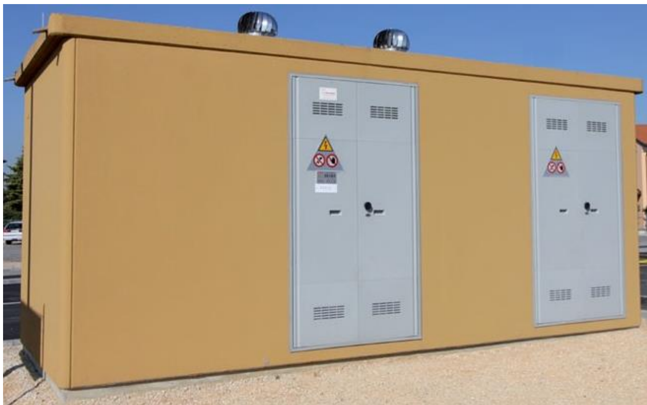
Figura 53 – Vista frontale cabina di trasformazione
