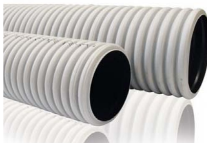
Fig. 21. Particolare del tubo corrugato di protezione dei cavi MT interni alla SSE.
