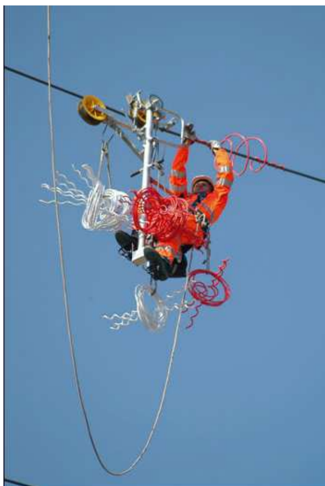
Figura 18-2: modalità di posizionamento delle spirali colorate sui conduttori
