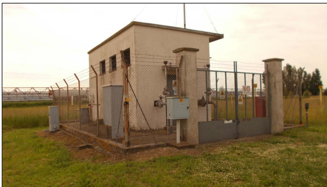
Figura 2.4-B - Cabina di Riduzione n. 645/A da rimuovere
