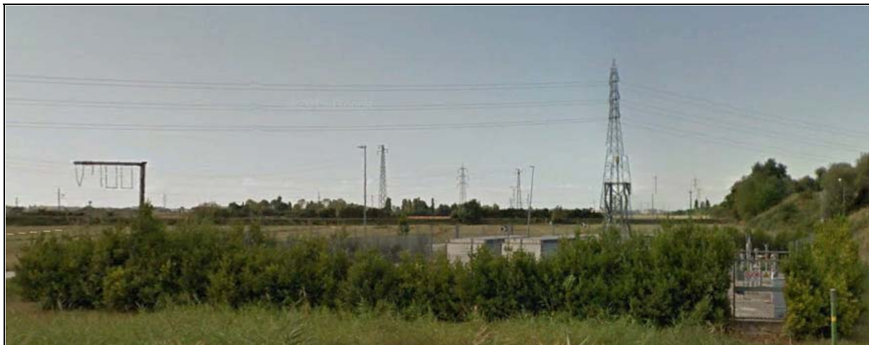
Figura 6.4-B - Stesso impianto con fascia arbustiva di mascheramento ormai attecchita
