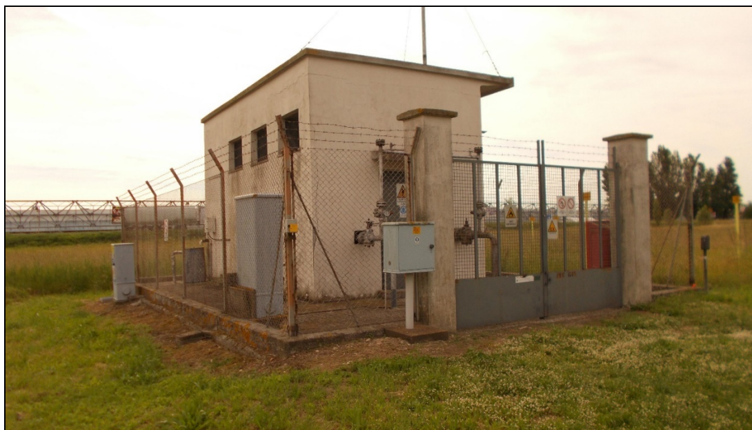
Figura 2 – Cabina di Riduzione n. 645/A da rimuovere
