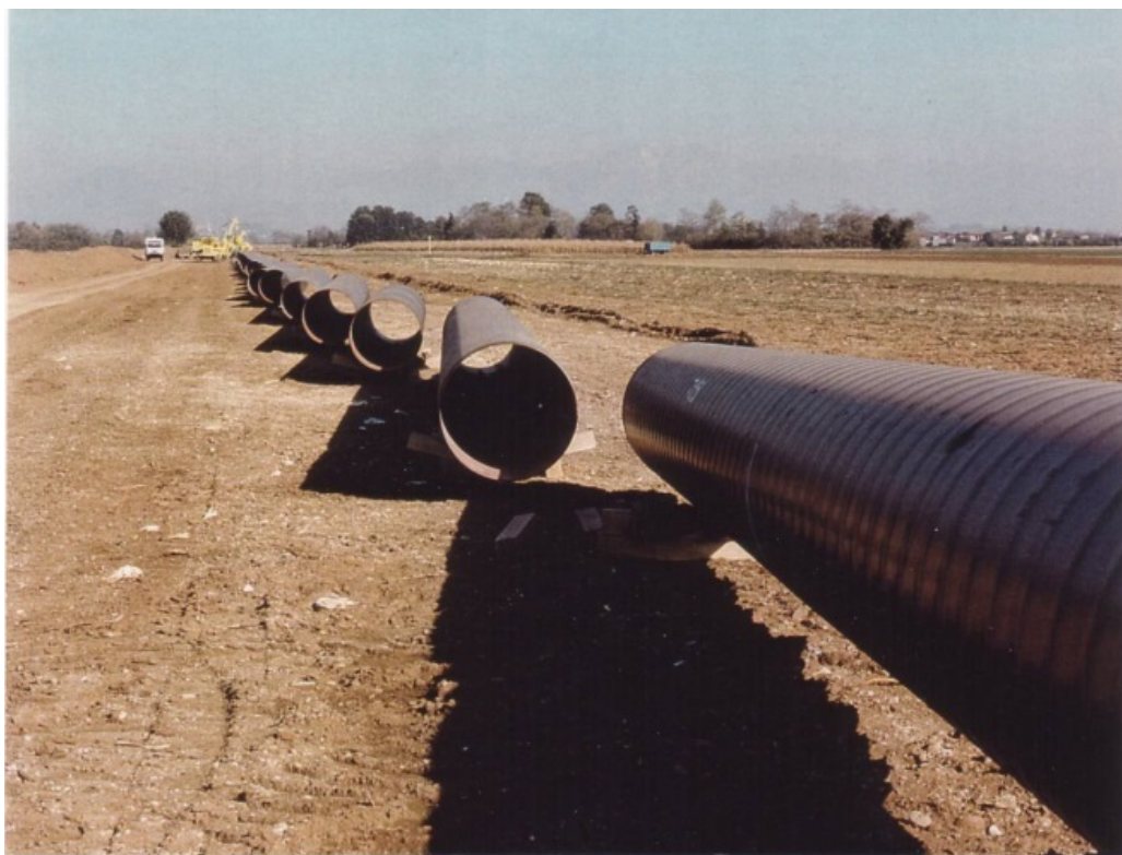
Foto 3.D: Esempio di sfilamento tubazioni
