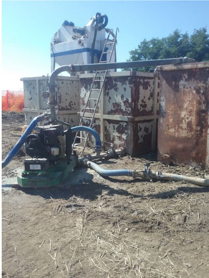
Allestimento di un impianto a circuito chiuso per la realizzazione di pali trivellati mediante l'utilizzo di fanghi bentonitici. In questa immagine si osservano la vasca prefabbricata per la decantazione del fango e la pompa di rilancio del fango verso il foro (immagine d'archivio)
