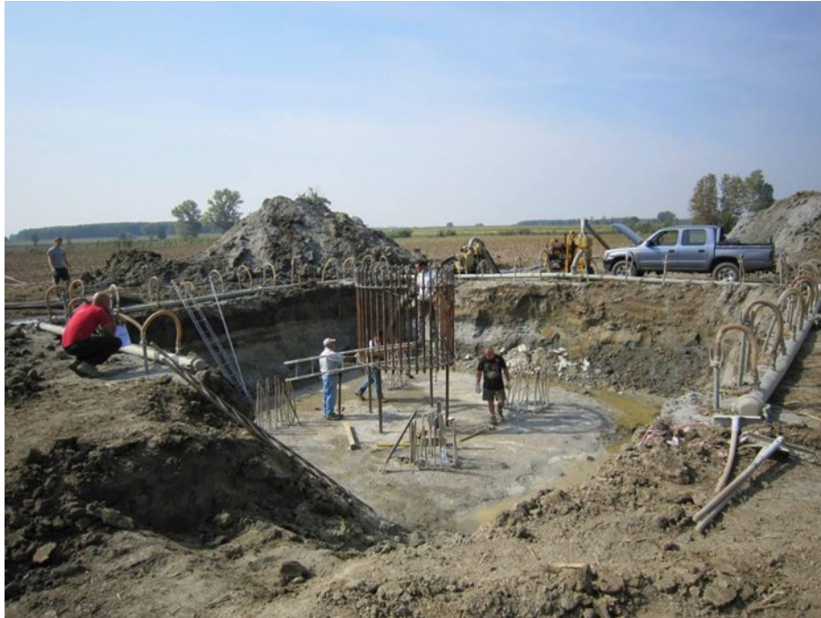
Realizzazione di una fondazione su pali trivellati per un sostegno monostelo. Nell'immagine si può osservare una fondazione in fase di realizzazione. Si possono distinguere facilmente i quattro pali trivellati già realizzati e gettati (si osservano le "ripresе" delle quattro gabbie metalliche), il piano di "magrone" sul quale impostare il monoblocco in cls e la gabbia di tirafondi appena posizionata (la quale verrà annegata nella fondazione). Si può infine osservare il sistema di wellpoint per l'aggottamento e smaltimento dell'acqua di falda a fondo scavo (immagine d'archivio)
