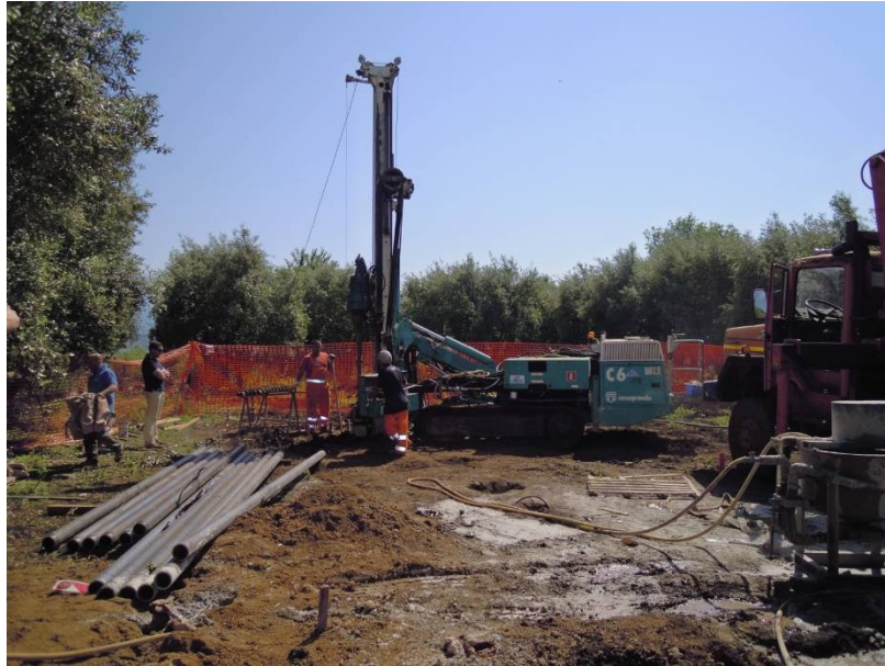
Cantiere per la realizzazione di micropali tipo tubfix; si può osservare sulla sinistra la zona di deposito dei tubolari metallici i quali costituiranno l'armatura dei micropali e sulla destra il miscelatore per la preparazione della boiaccia di cemento per l'iniezione a gravità dei micropali (immagine d'archivio)
