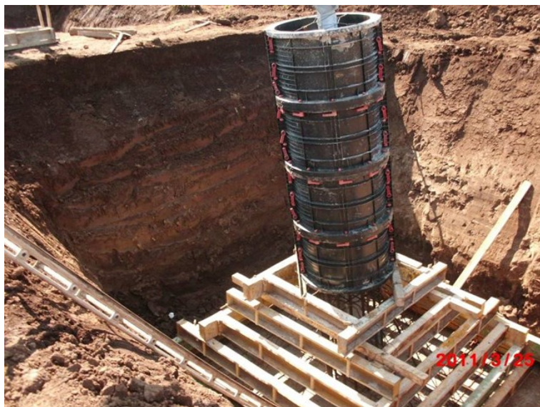
Realizzazione di fondazioni superficiali tipo CR per un sostegno a traliccio. Nell'immagine si può osservare la fase di cassetatura (immagine d'archivio)
