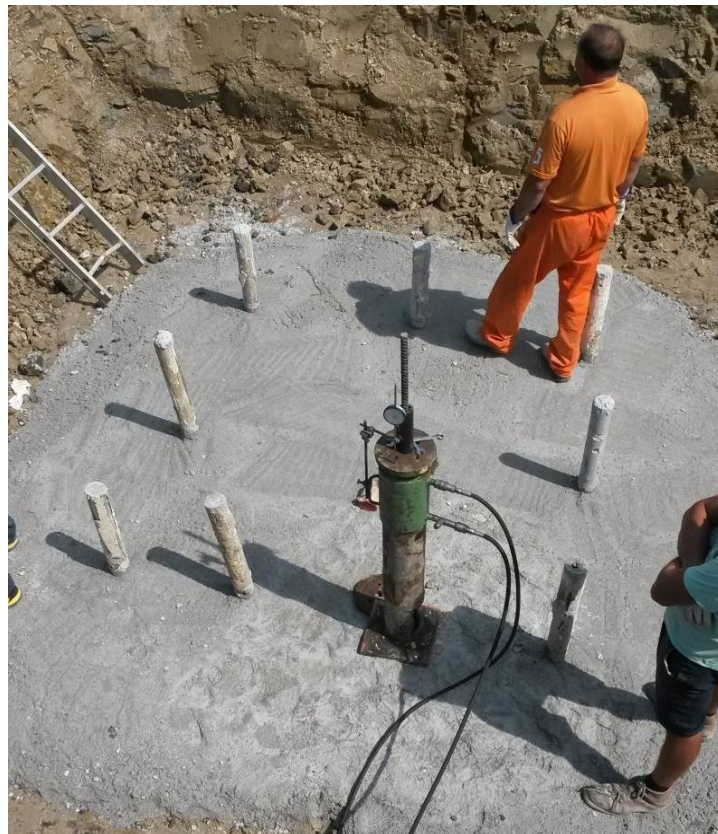
Realizzazione di micropali tipo tubfix per un sostegno a traliccio; si possono osservare i 9 micropali già realizzati ed iniettati; in questa fase, prima dell'armatura e cassetatura del plinto di fondazione, si sta eseguendo una prova di tenuta del micropalo allo strappamento, al fine di verificare la corretta progettazione e realizzazione dello stesso (immagine d'archivio)
