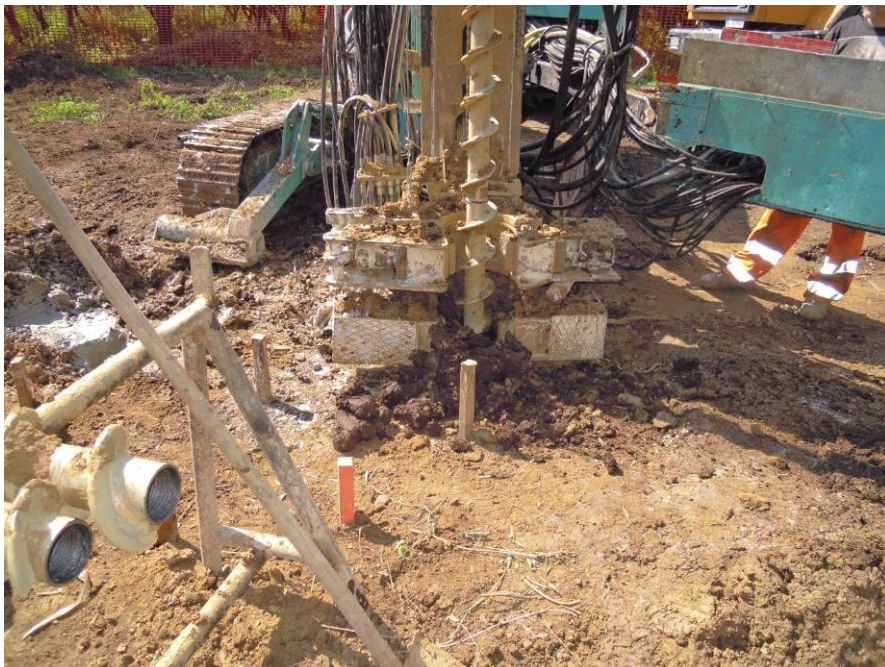
Macchina operatrice per la realizzazione di micropali tubfix; sistema di scavo mediante trivella elicoidale (immagine d'archivio)
