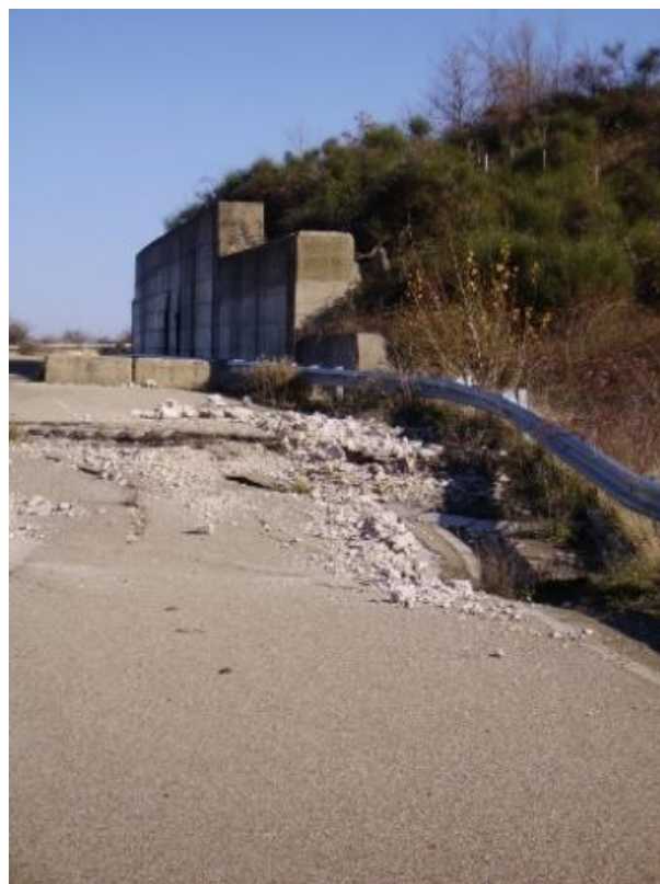
Figura 9-14 Svincolo Pescopagano, punto B (rottura e ribassamento sede stradale, 2004)
