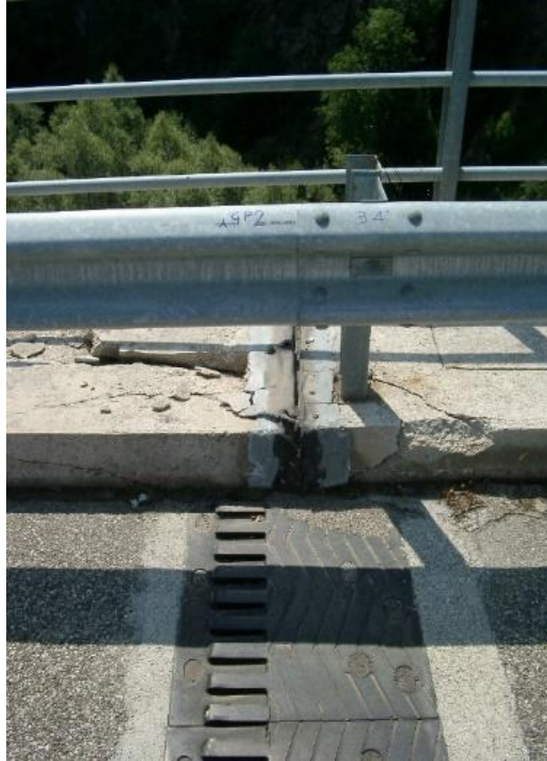
Figura 9-15 Viadotto Ficocchia. Chiusura del giunto e rottura a compressione di un bordo in cls dell'impalcato
