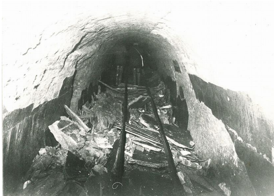
Figura 5-9 Esempio di dissesto della Galleria Pavoncelli dell'EAAP a seguito del terremoto del 1980.
