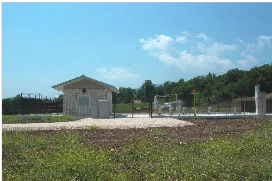
Fig. 2.25 - Punto di Intercettazione di linea (PIL).
