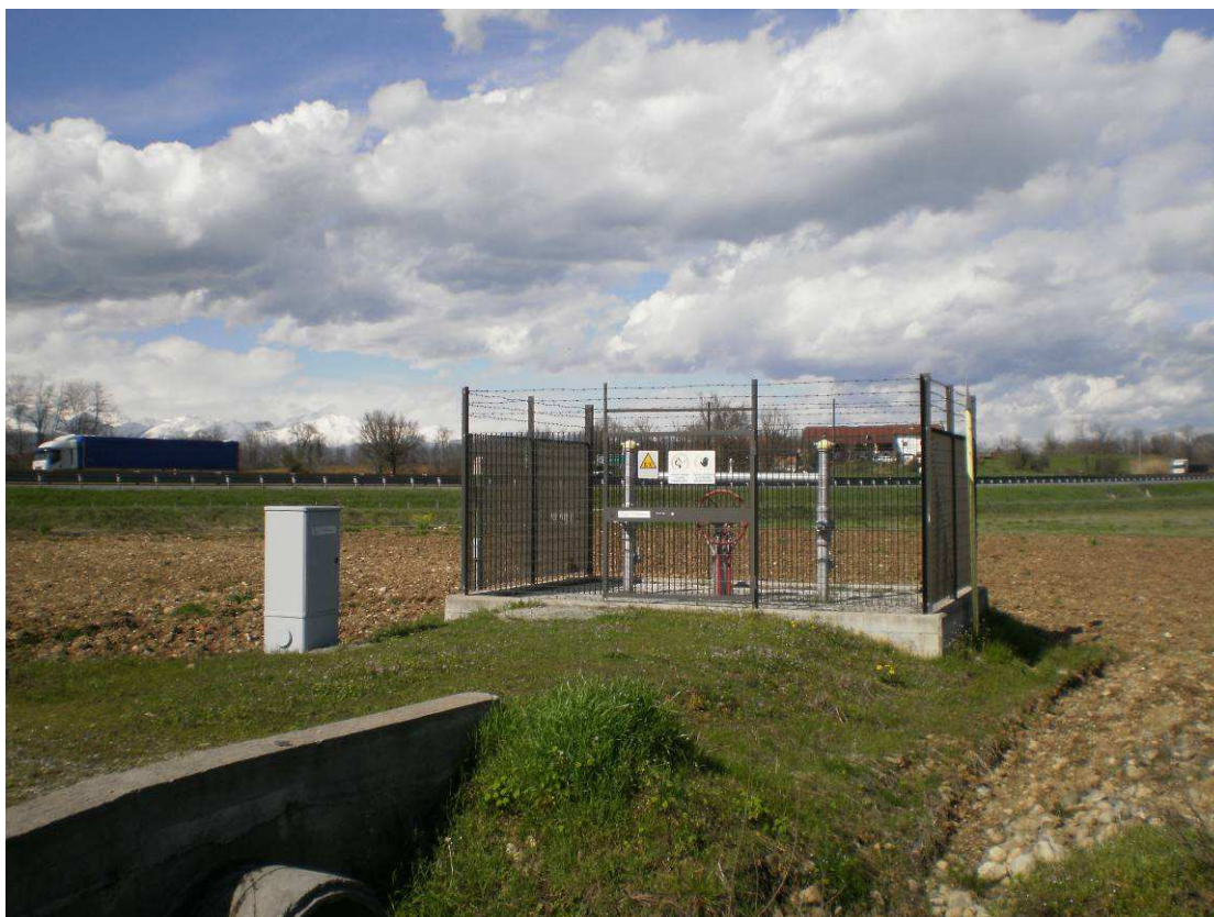
Fig. 2.22 - Esempio di impianto di intercettazione di linea PIL.
