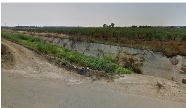
Figura 23. Immagine di un tratto di canale a sezione trapezia ricoperto di vegetazione. La foto è stata presa in corrispondenza del punto A indicato in Figura 22.
