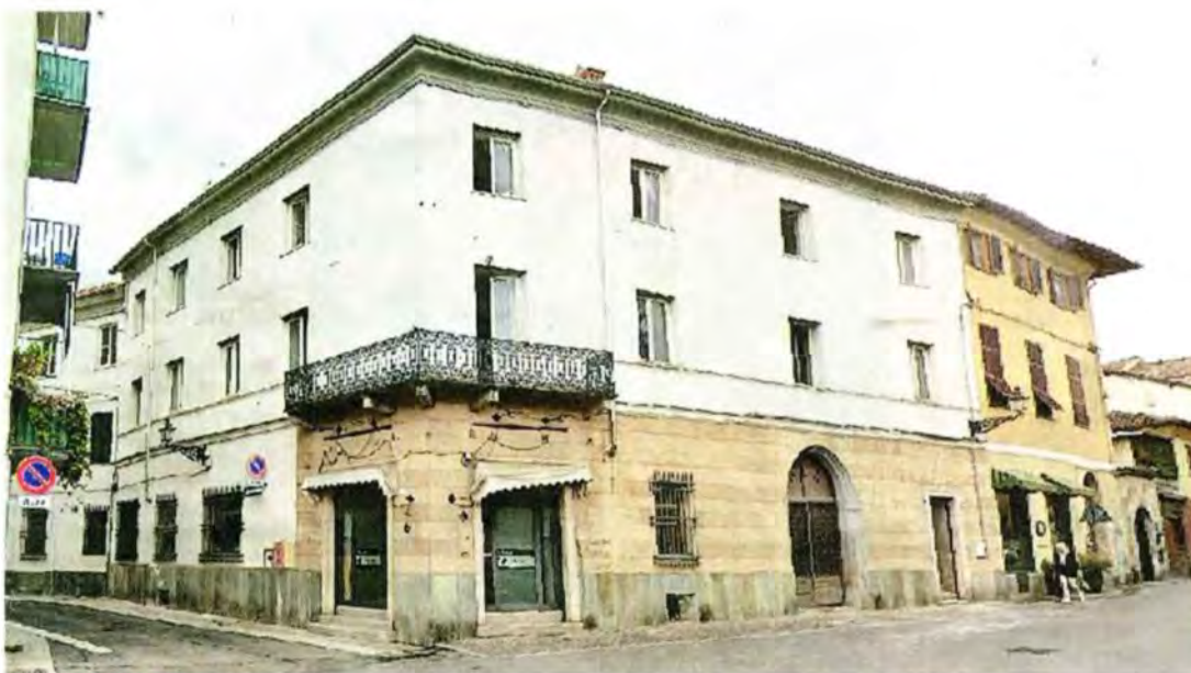
ALBERGO BOLOGNA L'edificio di via Cavanna, che un tempo ospitava un hotel, sarà restaurato: il Comune ha dato il via libera
